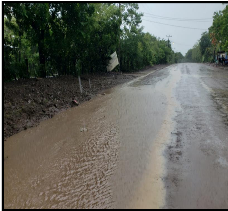
Imagen 1. Estado actual del camino.
