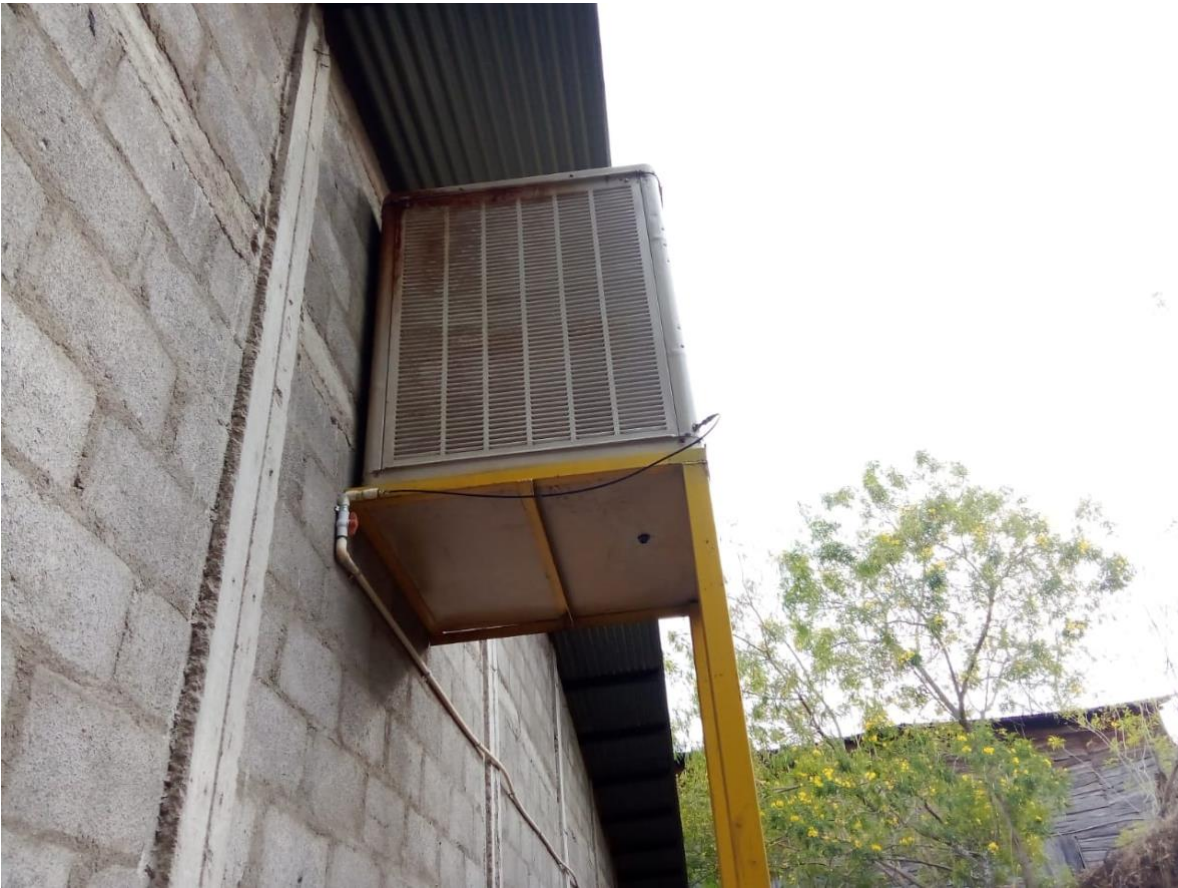
Ilustración 30. Ventilación del área de despalillo
