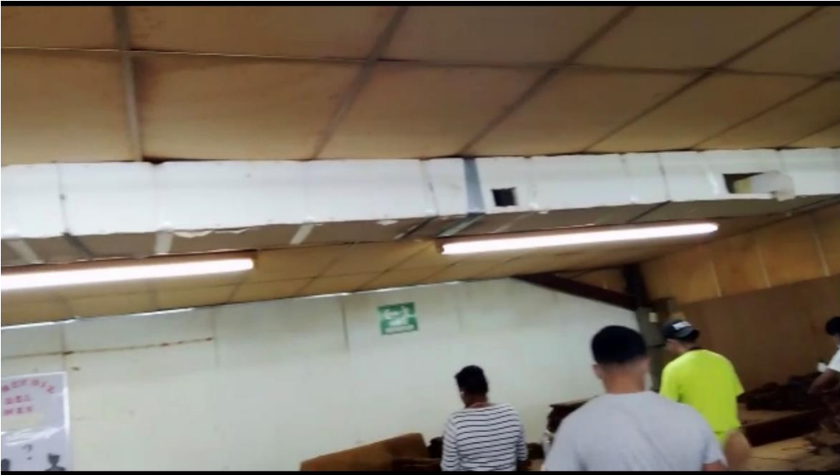
Ilustración 25. Ventilación para disminuir las altas temperaturas
