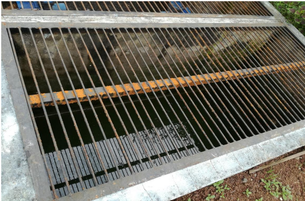
Tanque de lixiviados
