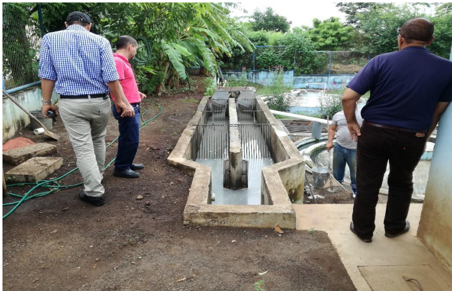
Pre tratamiento (desarenador y rejillas)
