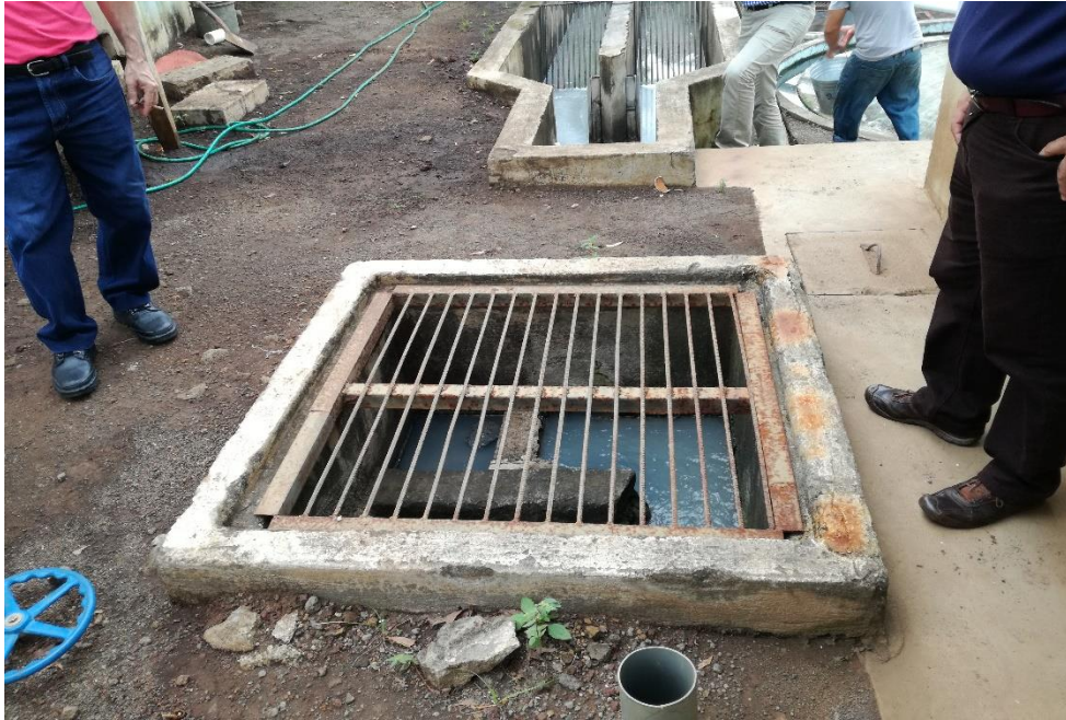
Entrada del agua residual a la PTAR
