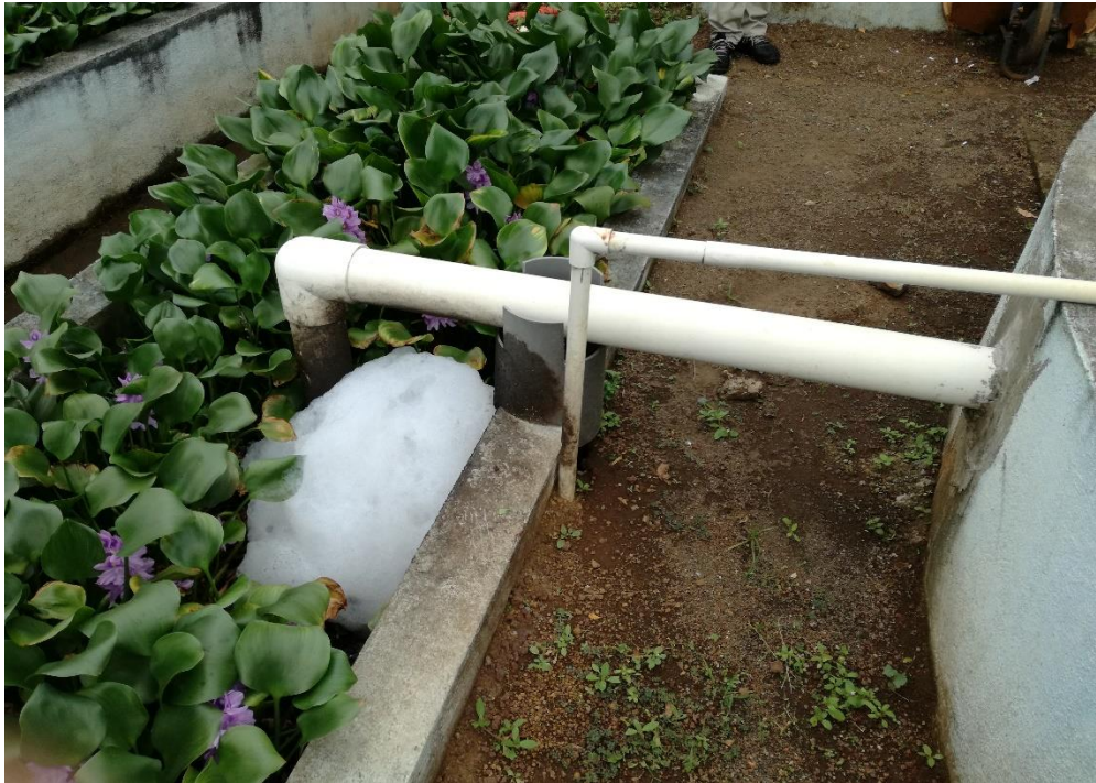
Ingreso del agua residual proveniente de los reactores al humedal
