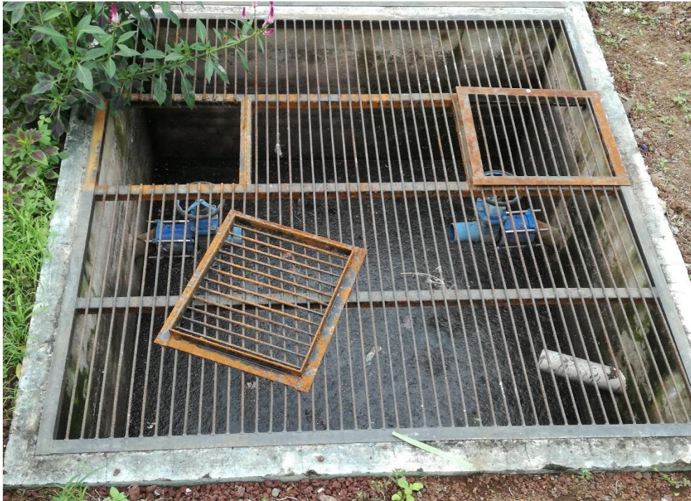
Lecho de secado de lodos
