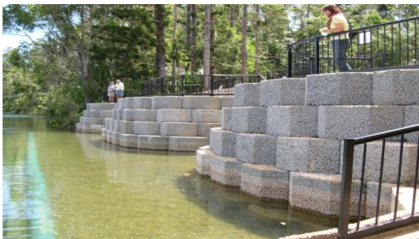
Figura 19. Muro de retención expuesto a la acidez del agua.
