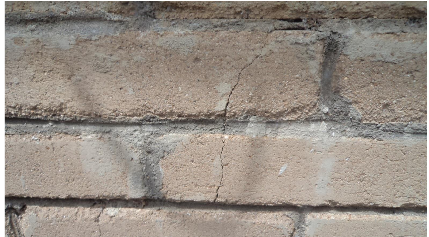
Fractura leve del material luego del movimiento sísmico
