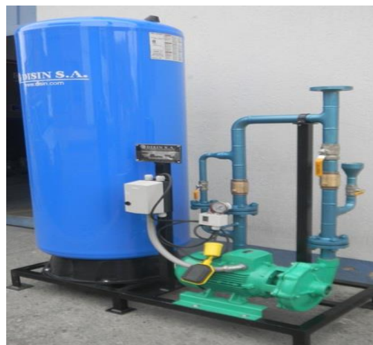
Fig. 2 Equipo hidroneumático de presión constante
