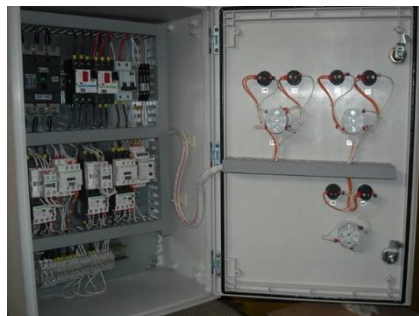
Fig. 10 Tablero de control
