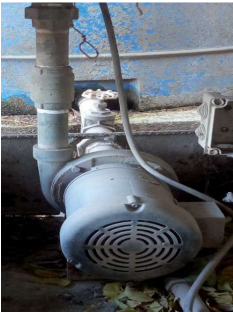
Fotografía 3: Bomba de agua
