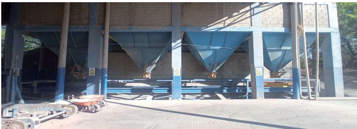
Fotografía 1: Silos de agregados
