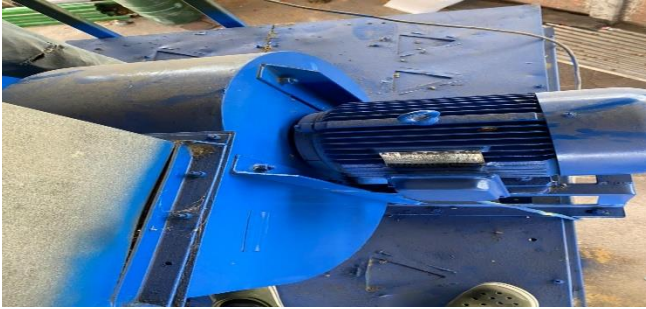
Figura 13. Motor trifásico del ventilador. (Fuente propia)
