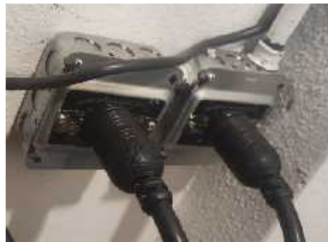
Ilustración 21: Conexiones de baterías a la Fuente
