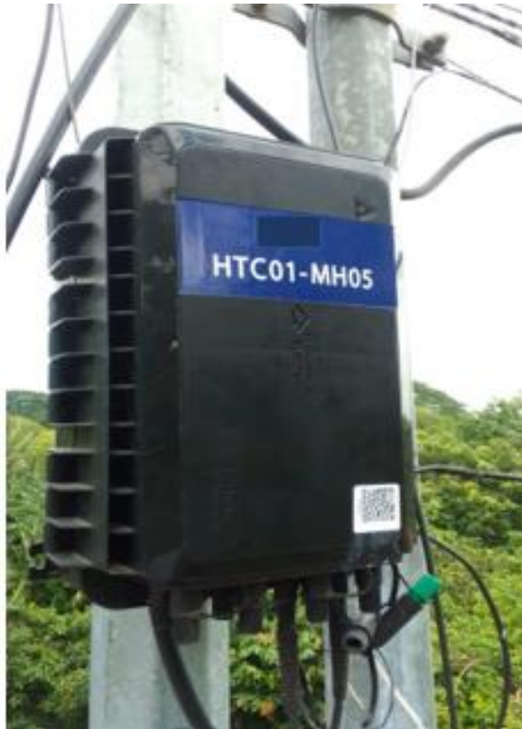
Figura 53: Mini Hub instalado.
