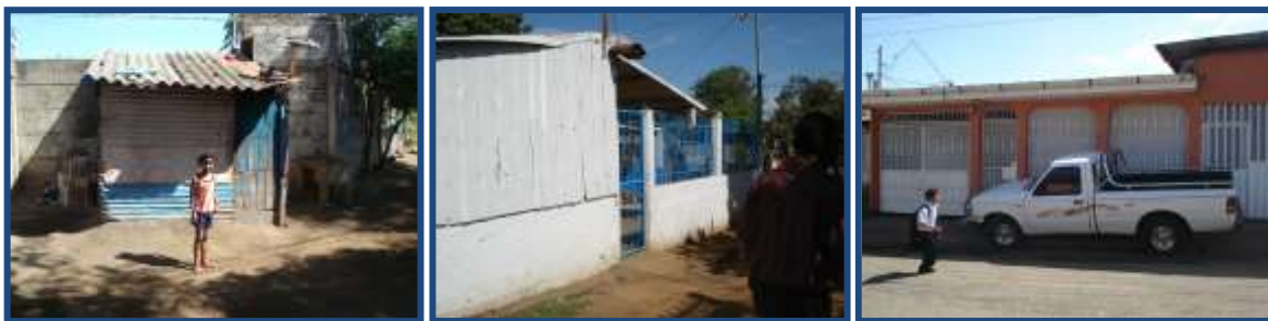
Foto 26: Viviendas en mal, Regular y buen estado en el subsector Fuente: Irañeta, Mayorga, y Gutiérrez 2008.
