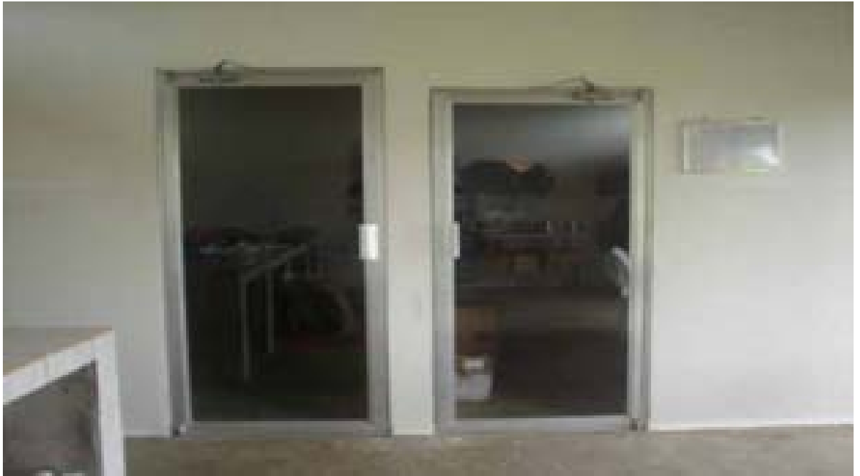
Figura No. 7. Puertas internas de vidrio
