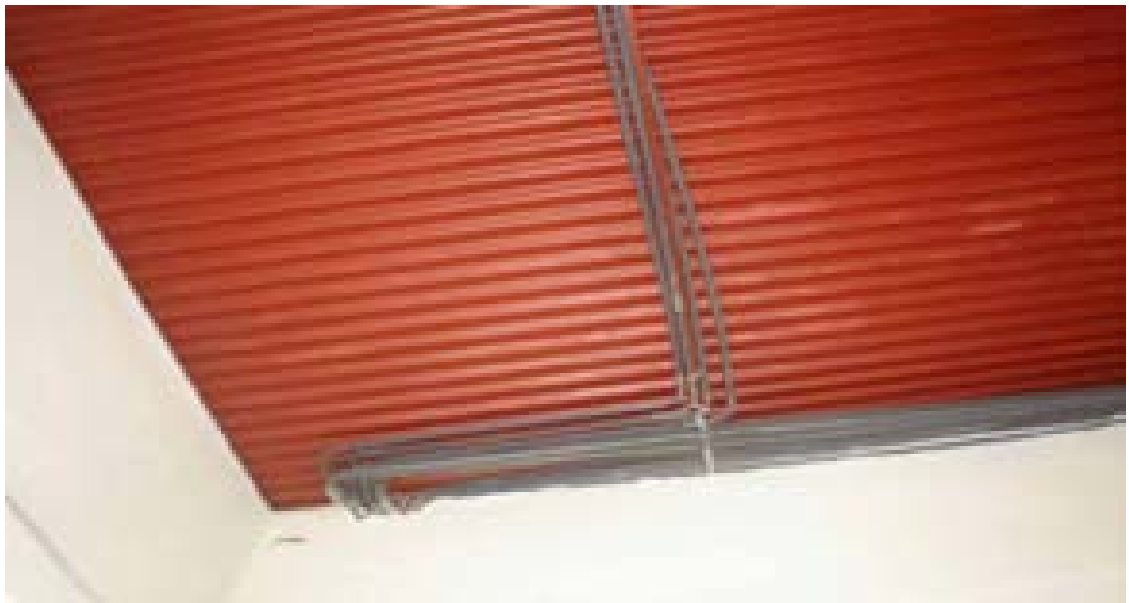
Figura No. 11. Cables entubados de la planta.
