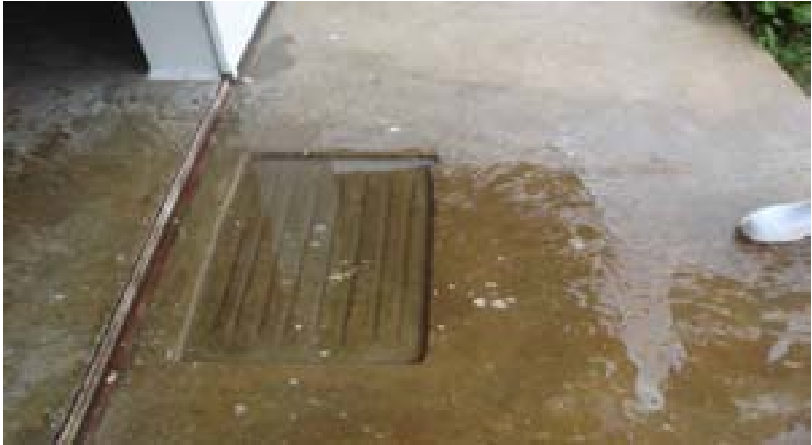
Figura No. 10. Pediluvios de la planta.
