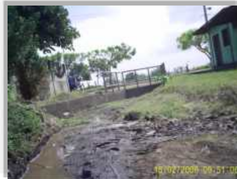
Foto N° 18: Carencia de drenaje pluvial Fuente: Elaborado por Díaz, Jiménez y López, 2008
