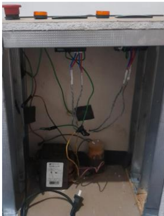
Figura #11 Cabina de control dispositivo de placa protegida, se puede observar el laborioso trabajo de instalación eléctrica, 2023, Managua
