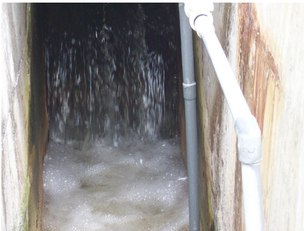
Figura 3.1 Canales de entrada al sistema de tratamiento, PTAP de Boaco.
