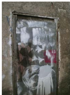
Foto 22: Puerta en mal estado, área del patio. Autores: Br. López/Morales, 2009.
