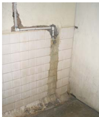
Foto 25: Tubería expuesta en el área de servicio sanitario. Autores: Br. López/Morales, 2009.
