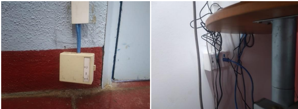
Figura 12. Canaleta Estructurada en Laboratorio de Computación
