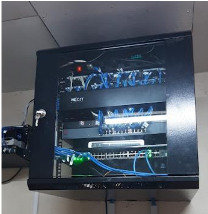
Figura 11. Gabinete Principal de Cuarto de Equipos
