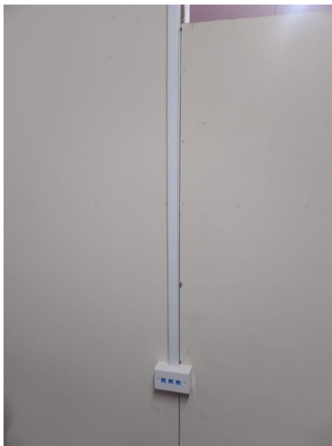
Figura 9. Canaleta Estructurada en Oficina TIC
