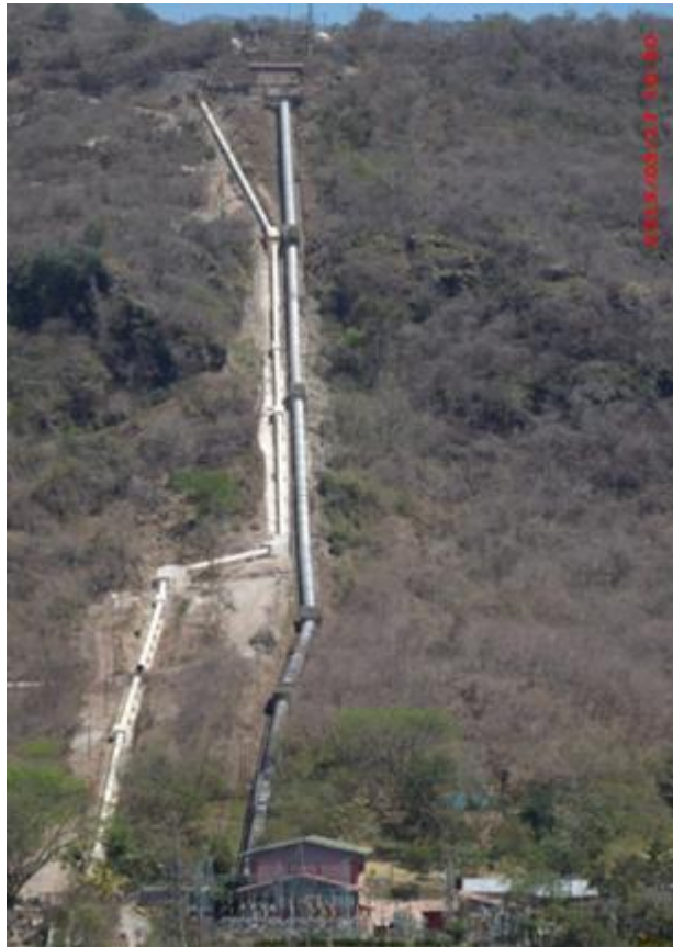
Tubería By Pass (Tubería a la izquierda)
