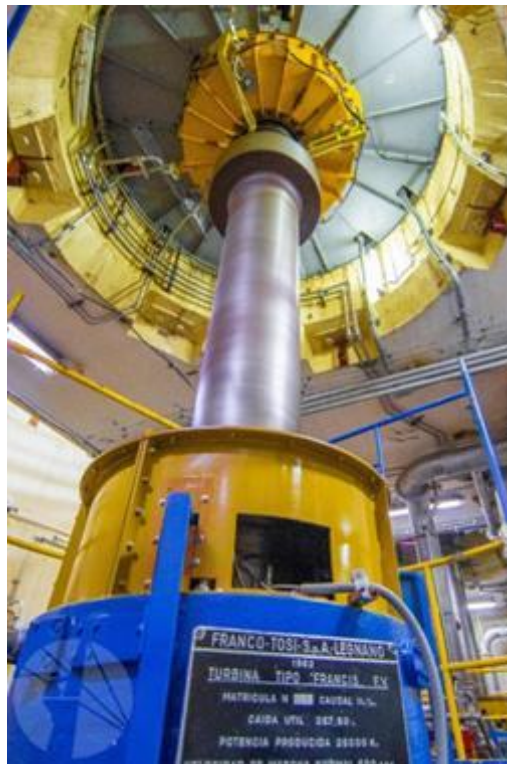
Turbina PCA y sección del eje que conecta al generador
