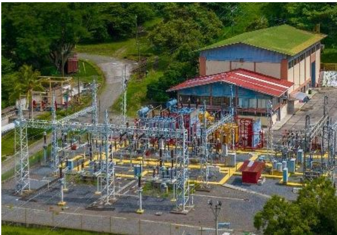
Casa de máquinas y subestación PCA
