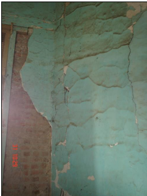
FOTO 52: GRIETAS Y DESPRENDIMIENTO DE APLANADO SALA PRINCIPAL
