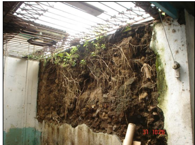
FOTO 58: VEGETACION EN MURO DE ADOBE
