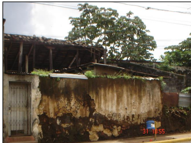
FOTO 56: DETERIORO EN TECHO FACHADA OESTE
