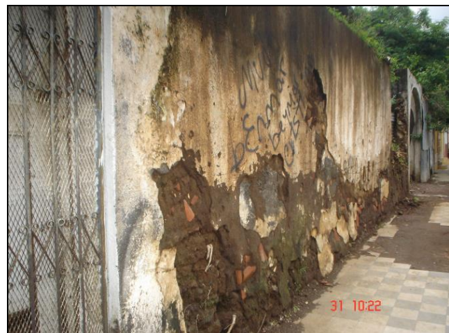
FOTO 59: DESPRENDIMIENTO EN MURO DE ADOBE
