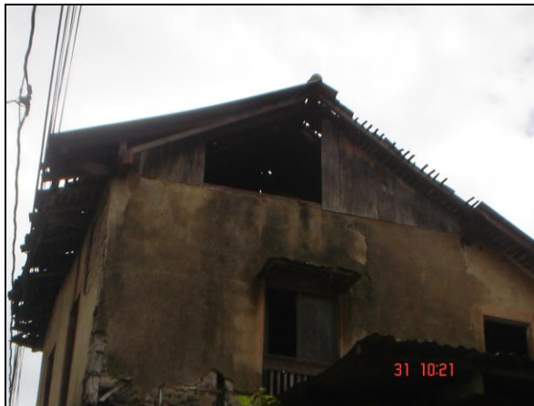
FOTO 54: DETERIORO EN MOJINETE FACHADA OESTE
