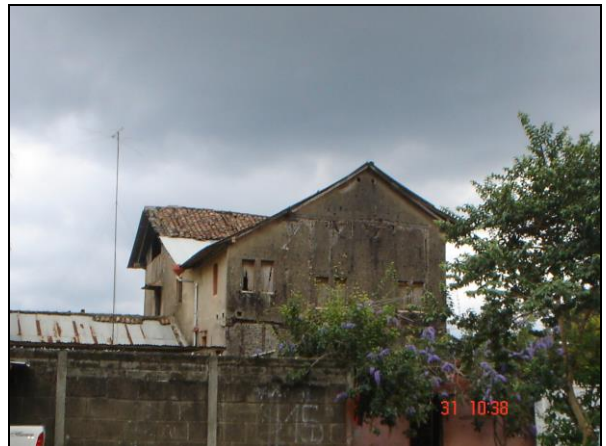
FOTO 55: DETERIORO EN TECHO FACHADA POSTERIOR
