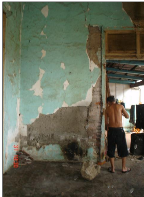
FOTO 53: GRIETAS Y DESPRENDIMIENTO DE APLANADO SALA PRINCIPAL
