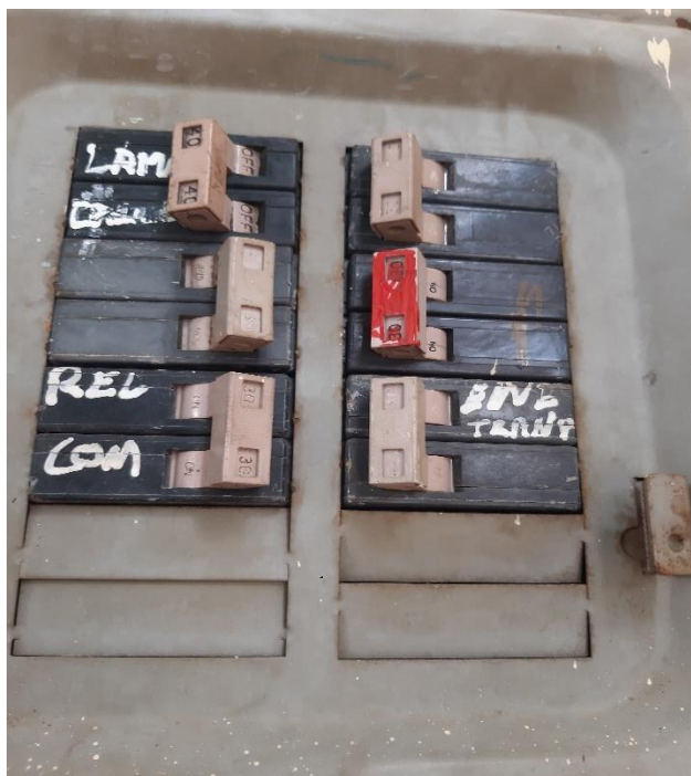
Ilustración 9. Centro de Cargas EATON 16 espacios, 2 polos 125A Fuente propia
