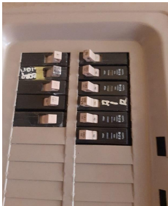
Ilustración 10. Centro de Cargas EATON 24 espacios, 2 polos 125A Fuente: Propia
