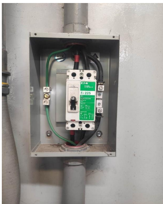
Ilustración 8. Interruptor EATON Fi 225, 2 polos 150A Fuente propia
