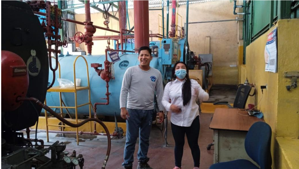
Área de caldera planta Novaterra, S.A. Fuente: autoría propia
