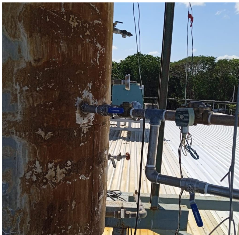
Válvula solenoide y tuberías para red de suministro a esterilizadores. Fuente: autoría propia
