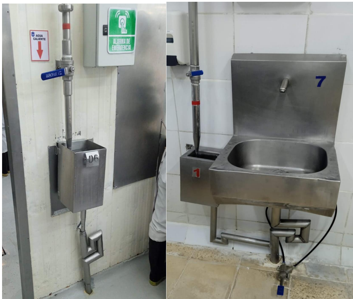
Esterilizadores planta Novaterra, S.A. Fuente: autoría propia
