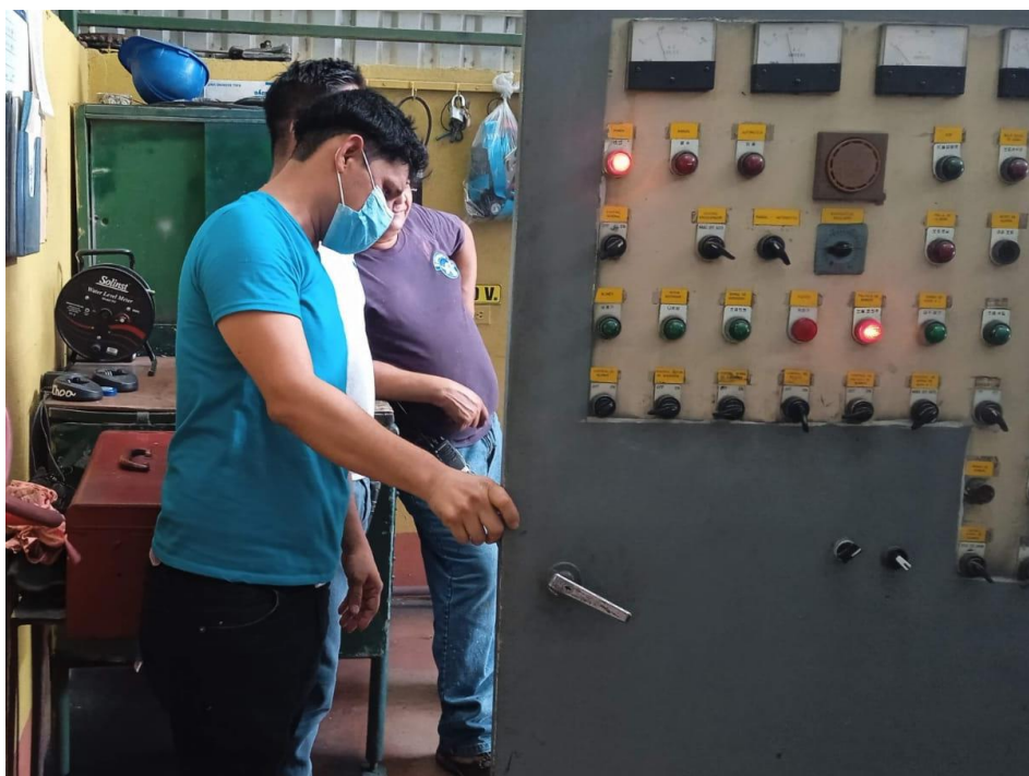
Panel de control área de caldera Fuente: autoría propia
