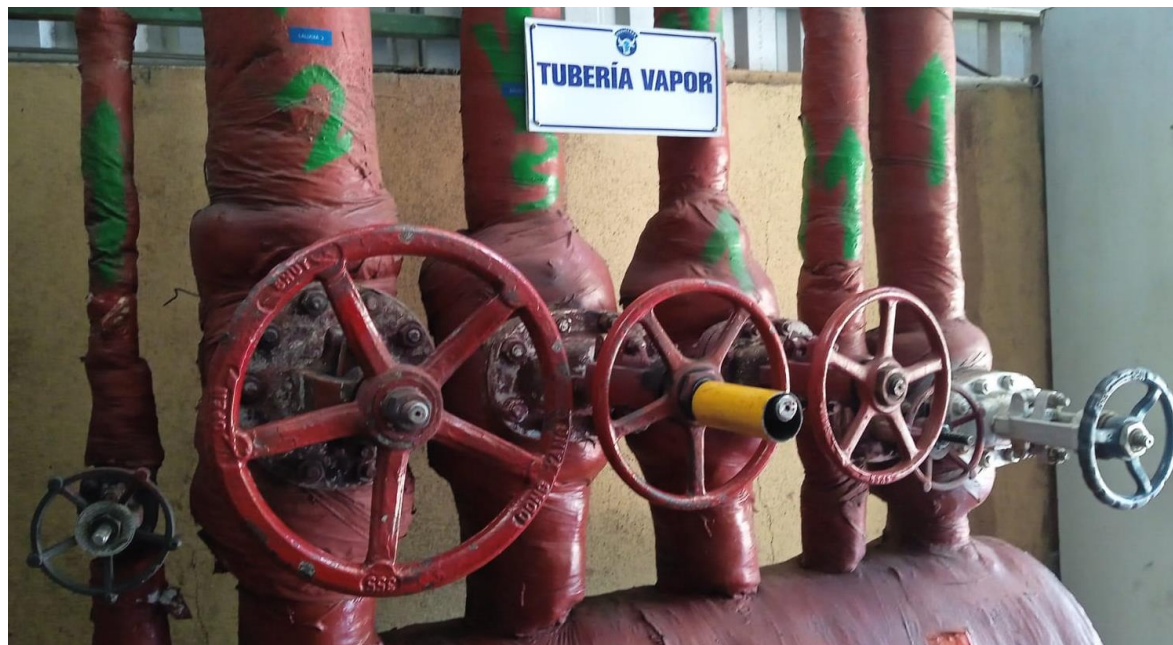
Distribución de tubería de vapor Fuente: autoría propia
