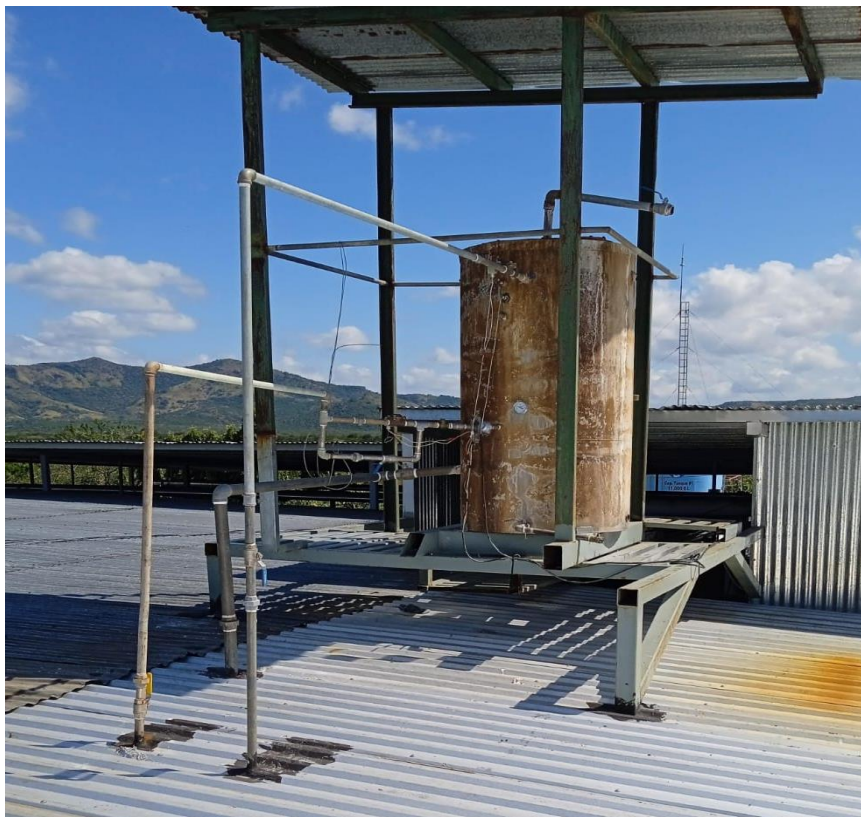
Tanque de agua caliente, planta Novaterra, S.A Fuente: autoría propia
