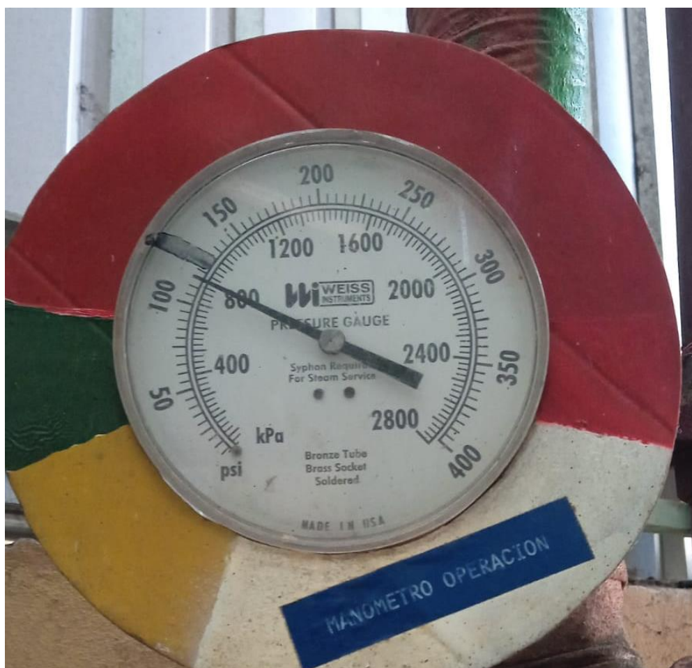
Manómetro para monitoreo de presión de vapor Fuente: autoría propia
