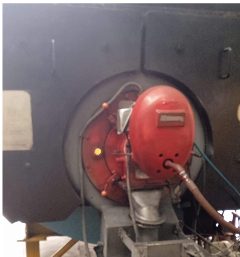
Caldera de planta Novaterra, S.A. Fuente: autoría propia
