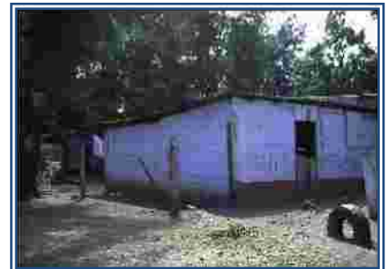
Mal Estado Físico
