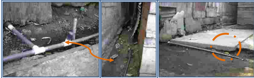
Fotografía No.37: Problemáticas de Tipo de Conexión de Agua Potable, Asentamiento Benedicto Valverde (Quinta Nina)
