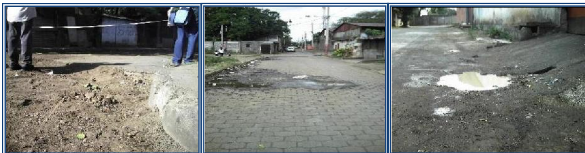
Fotografía No.29: Problemáticas de Infraestructura Vial del Asentamiento, Detectadas In Situ. Fuente: Levantamiento Fotográfico; Febrero 2008 – Grupo Monográfico.
