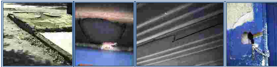
Fotografía No.41: Daños Constructivos
