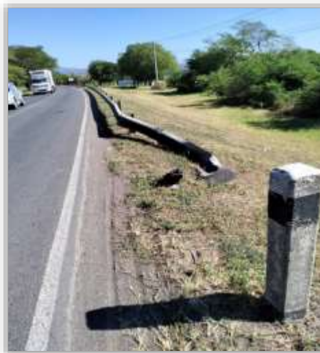
Figura 31: Extremo final de la defensa metálica km 110.000, se encuentra en mal estado
