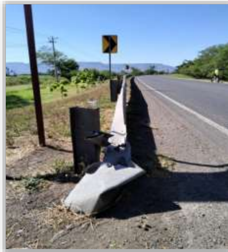
Figura 30: Inicio de la defensa metálica km 109.950, se encuentra en regular
