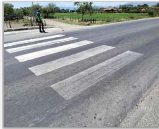
Figura 24: Cruce tipo cebra situado en el km 108.280, en estado regular
