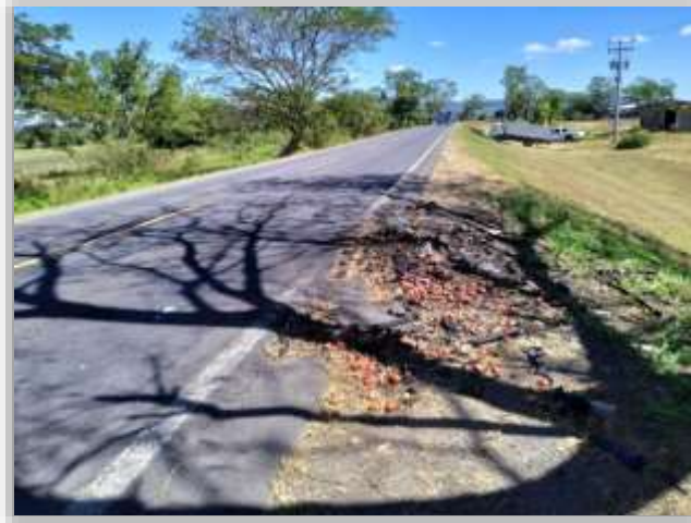
Figura 27: Línea de borde izquierda (sentido sur-norte), localizada en el km 111.800, en estado regular
