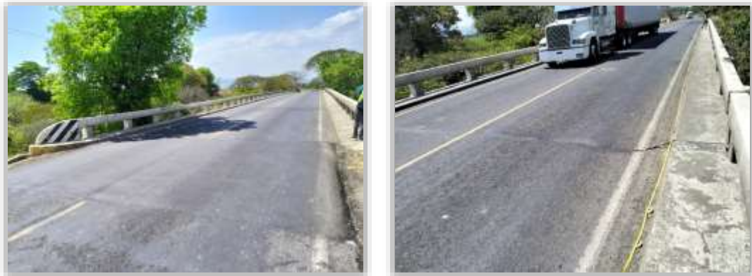
Figura 41: Condición del puente río viejo
