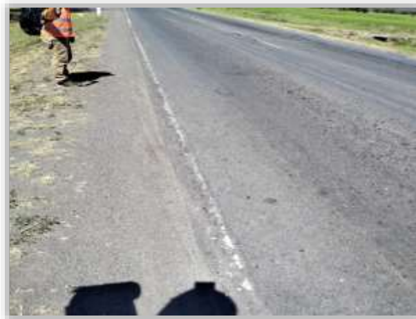
Figura 26: Líneas laterales y línea central, ubicadas en el km 110.720, en mal estado
