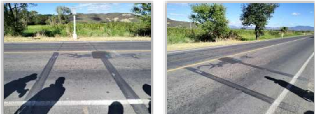
Figura 39: Reductor de velocidad deteriorado, km 112.937 carretera panamericana norte Sébaco, Matagalpa
