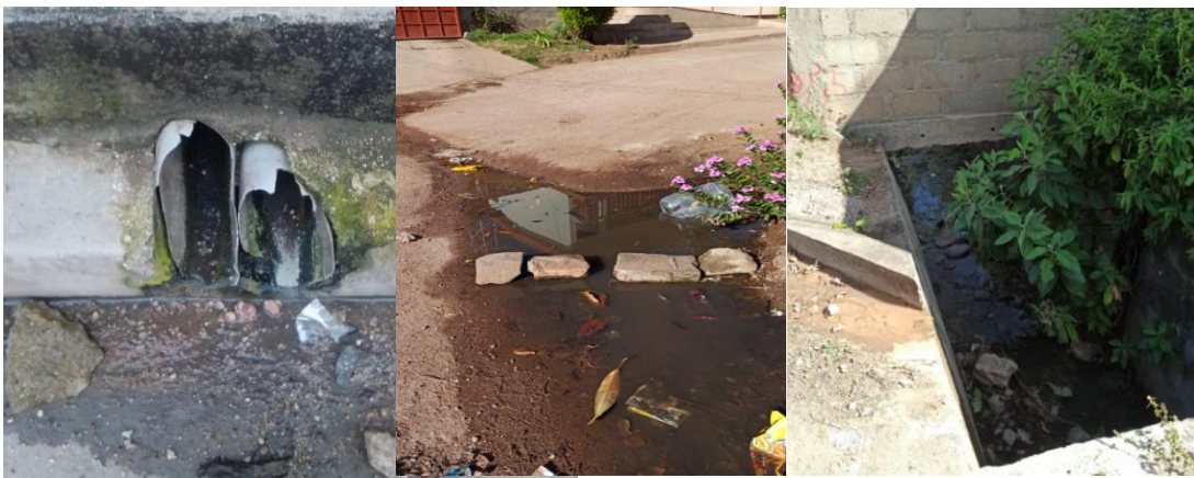
Figura 11: Esguerrimiento de aguas grises en cunetas y calles, Totogalpa
