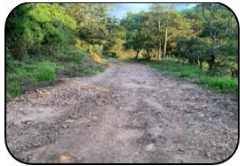
Foto 3. Inexistencia de drenaje (Est. 1+40).
