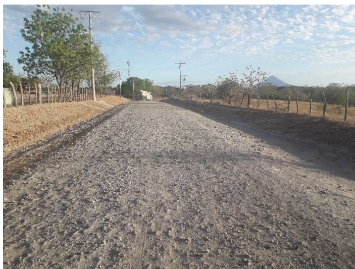
Figura 14: Deterioro en la superficie de rodamiento del tramo.
