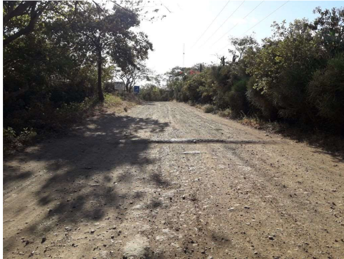
Figura 15: Deterioro en la superficie de rodamiento del tramo.
