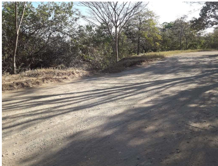
Figura 16: Deterioro en la superficie de rodamiento del tramo y ausencia de obras de drenaje.
