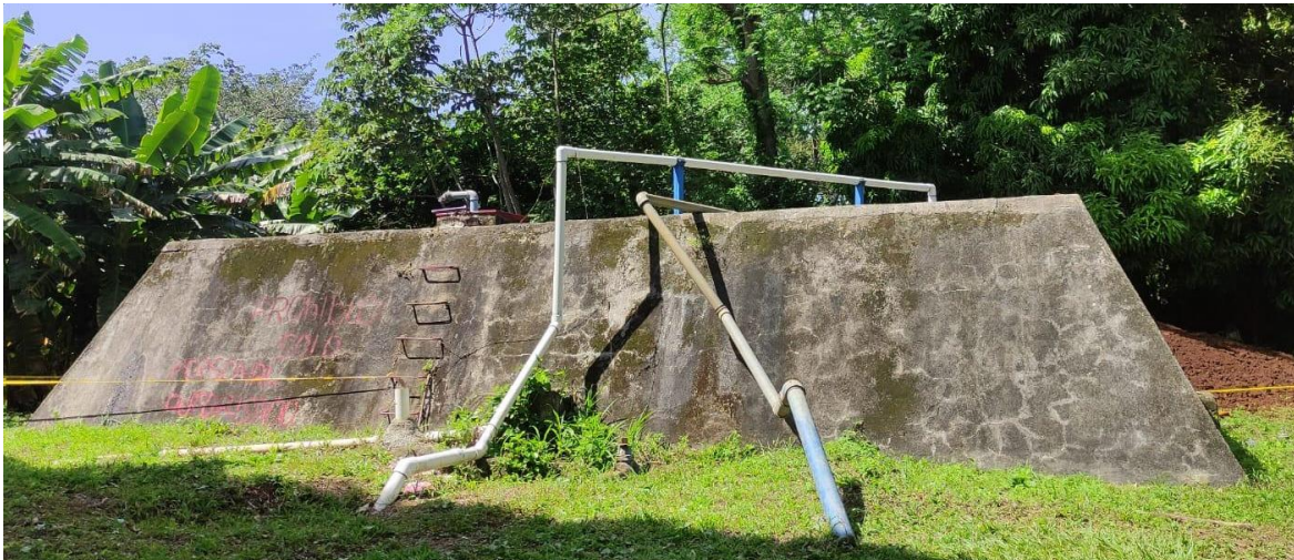
Figura 34 Tanque de almacenamiento existente.
