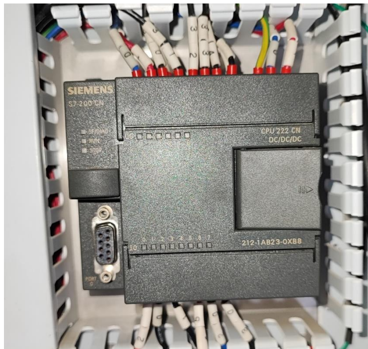
Figura 32. Controlador lógico programable antes de actualización
