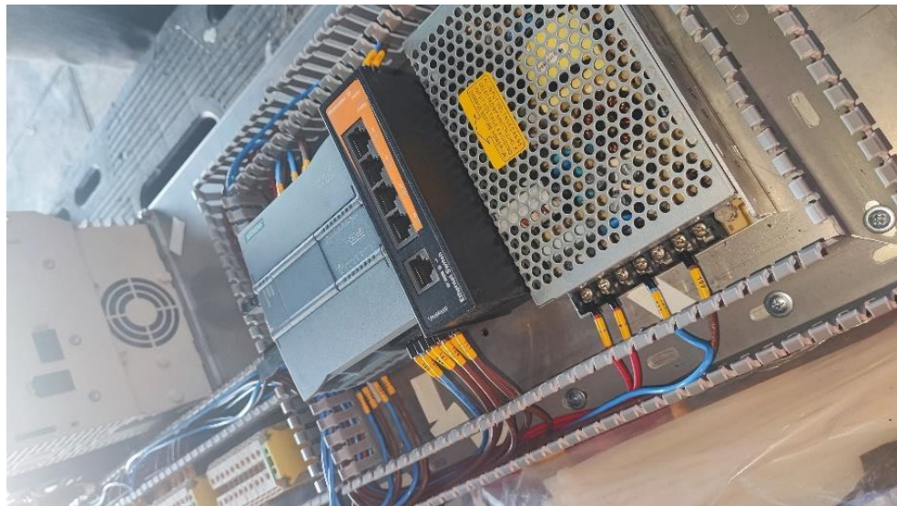
Figura 47. Cableado de panel eléctrico
