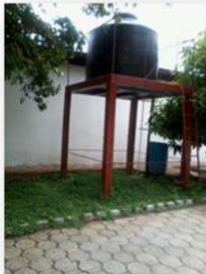
Ilustración 20 Tanque de almacenamiento de agua potable
