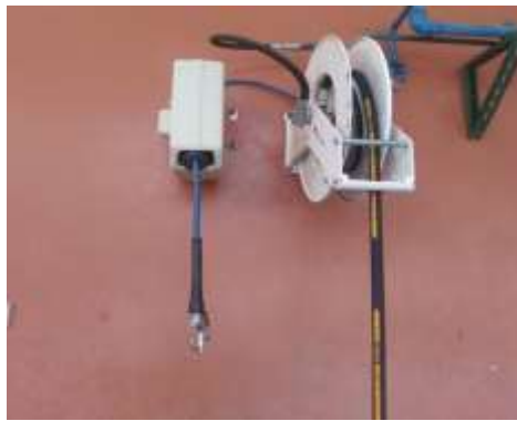
Imagen #13 Manguera de agua y de aire
