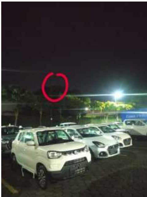
ANEXO 4 LUMINARIA EN MAL ESTADO
