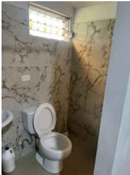
Figura 12. Instalaciones sanitarias de Purificadora de Agua Manantial Dios Agua Viva.
