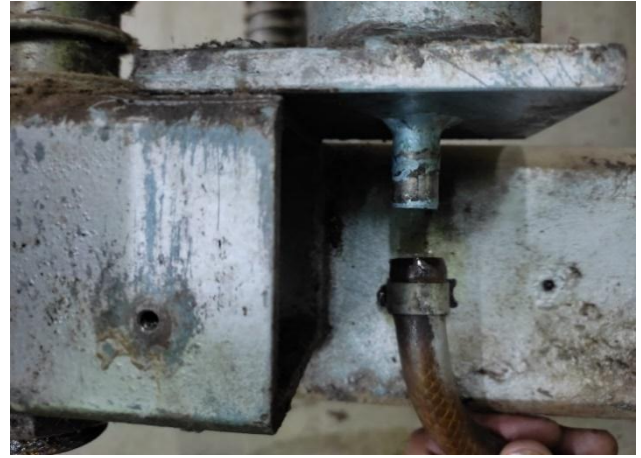
Figura 30: Detalle manguera de PVC para alimentación del fluido hidráulico. (fuente propia)
