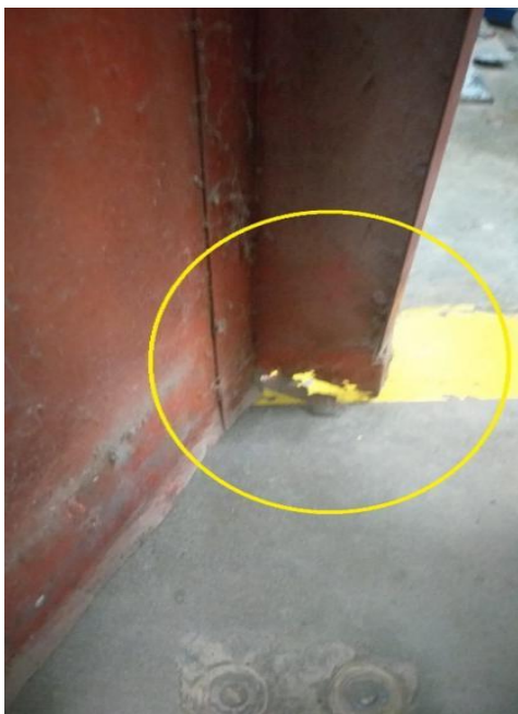
Figura 12: Presencia de corrosión y picaduras en carcasa. (Fuente propia)
