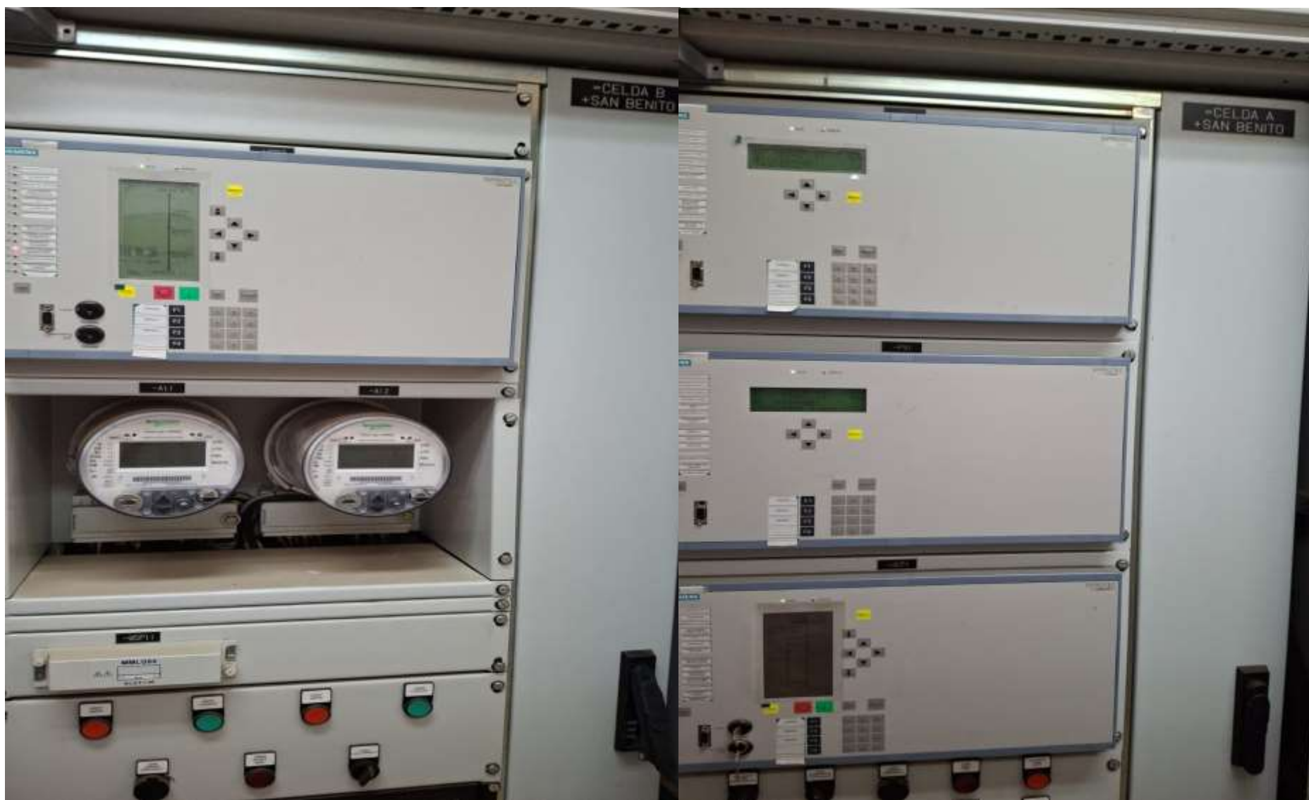
Figura 34. Equipos de la subestación eléctrica Masaya.
