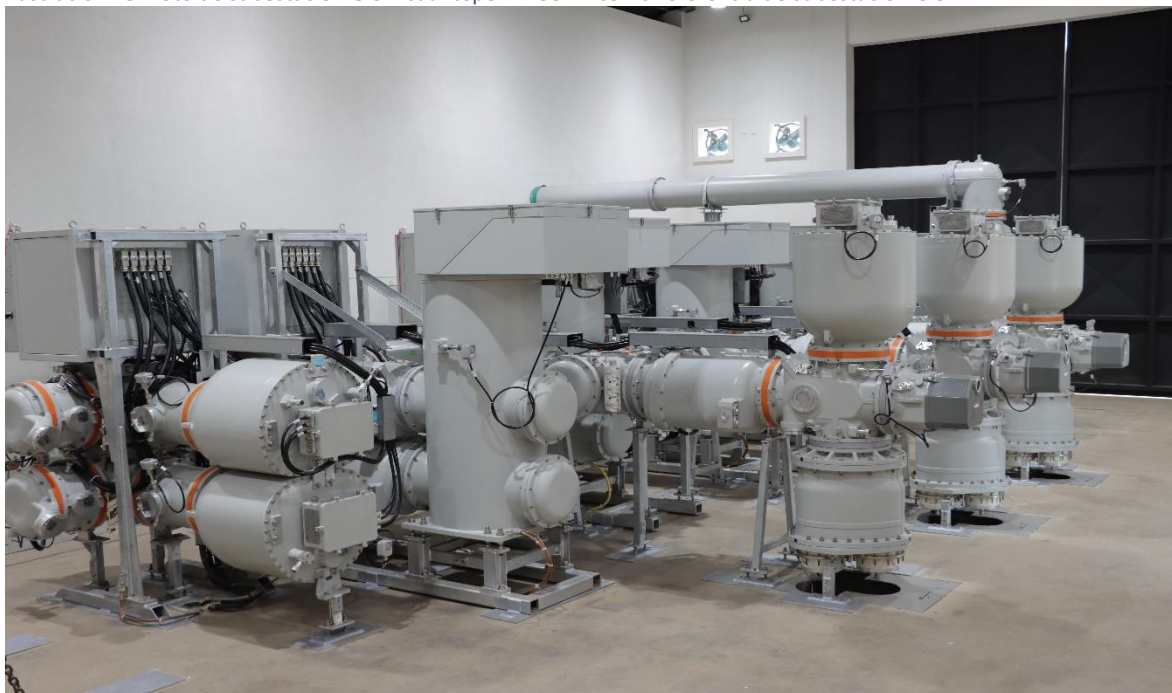
Ilustración 43. Foto de subestación GIS Ticuantepe III 138 kV como referencia de subestación GIS
