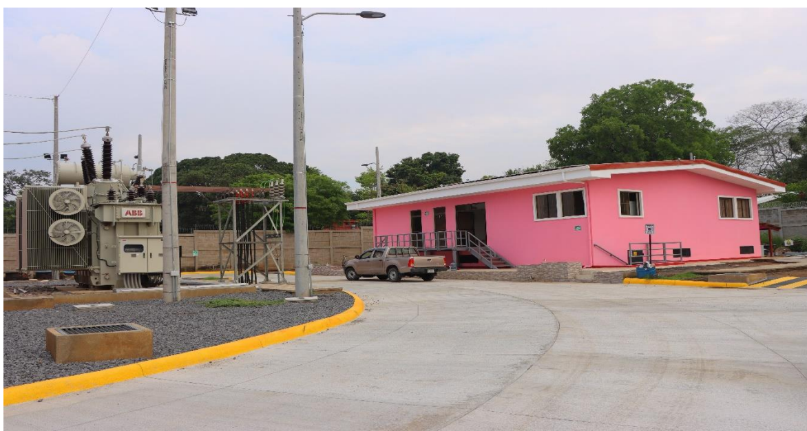
Ilustración 45. Foto de subestación GIS Ticuantepe III 138 kV como referencia de subestación GIS
