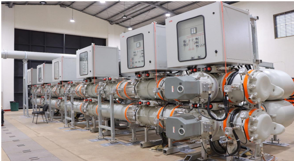
Ilustración 42. Foto de subestación GIS Ticuantepe III 138 kV como referencia de subestación GIS
