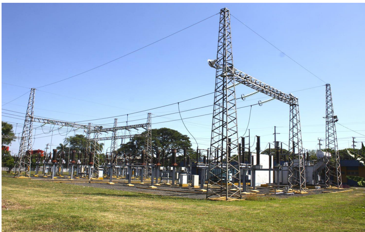
Ilustración 41. Foto de Subestación Altamira.
