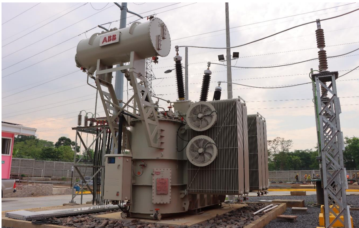
Ilustración 44. Foto de subestación GIS Ticuantepe III 138 kV como referencia de subestación GIS
