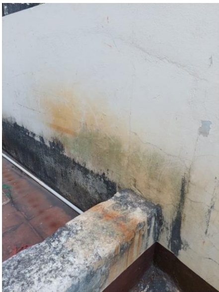
Humedad y corrosión
