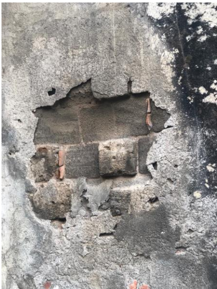
Desprendimiento en muro
