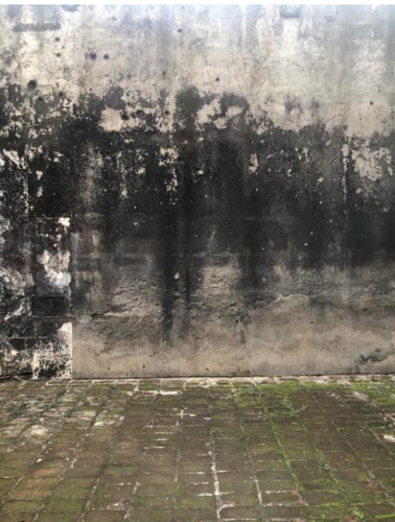
Humedad en muros
