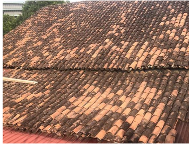
Imagen 50. Tejas de barro en cubierta, costado oeste. Fuente: Propia.
