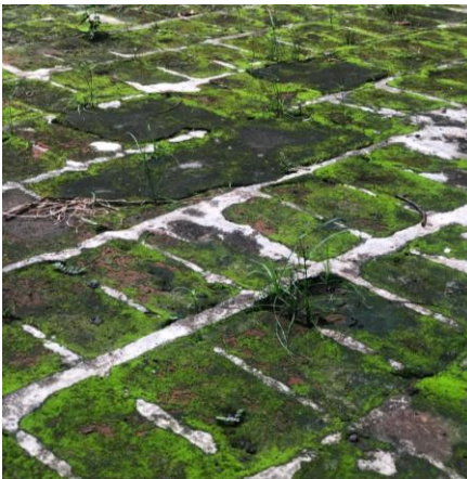
Humedad en pisos
