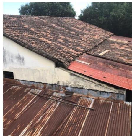
Oxidación y corrosión
