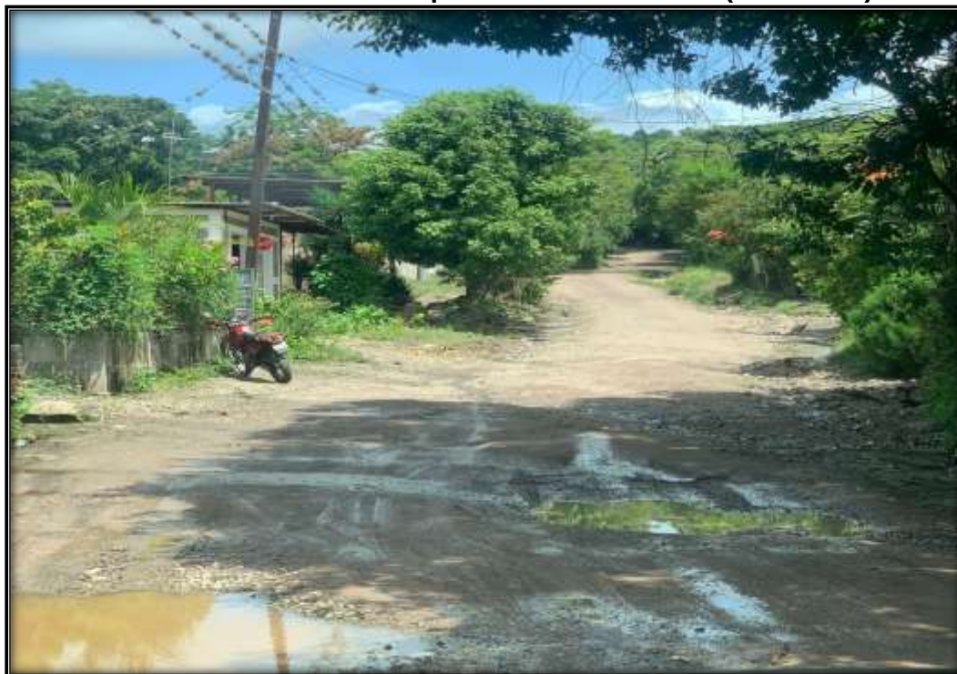
Foto 7. Mal estado de la superficie de rodamiento (Est. 1+000).
