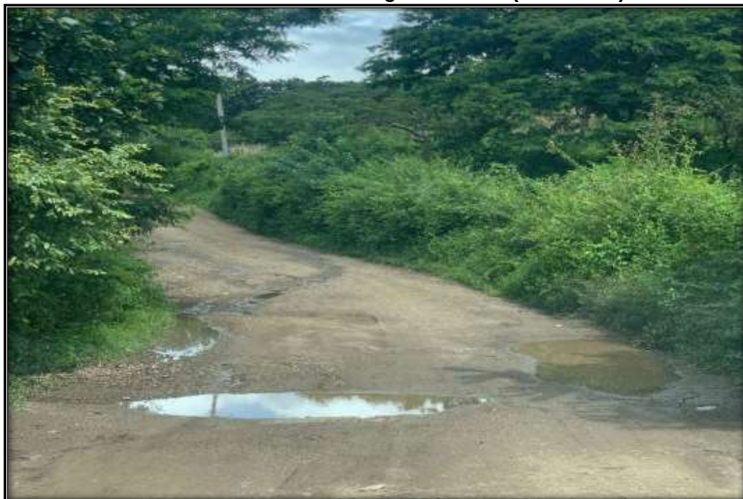
Foto 5. Estancamiento de agua en la vía (Est. 0+360).
