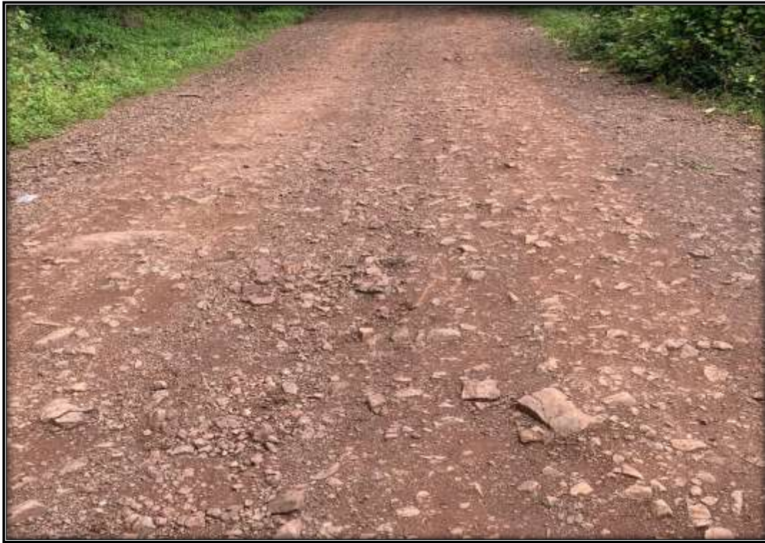
Foto 3. Desgastes de la superficie de rodamiento (Est. 0+240).
