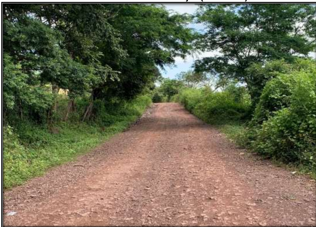
Foto 2. Inexistencia de drenajes (Est. 0+100).
