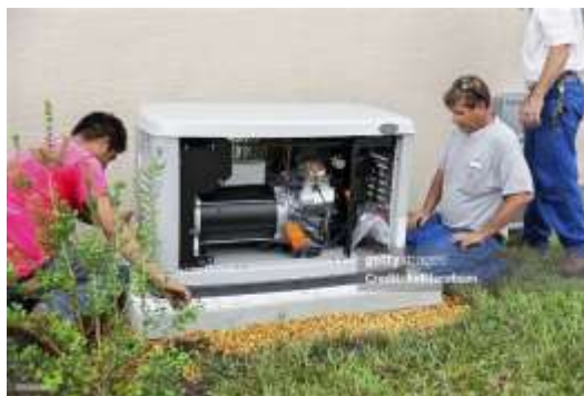
Imagen #7. Generador de Diesel. Fuente: www.gettyimages.es
