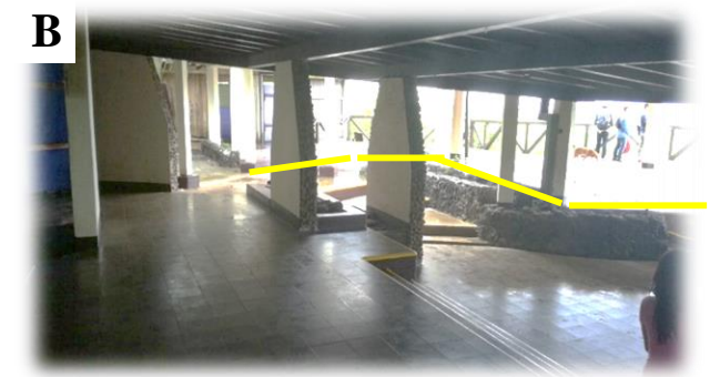
Imagen 46. Escaleras sin pasamanos.
