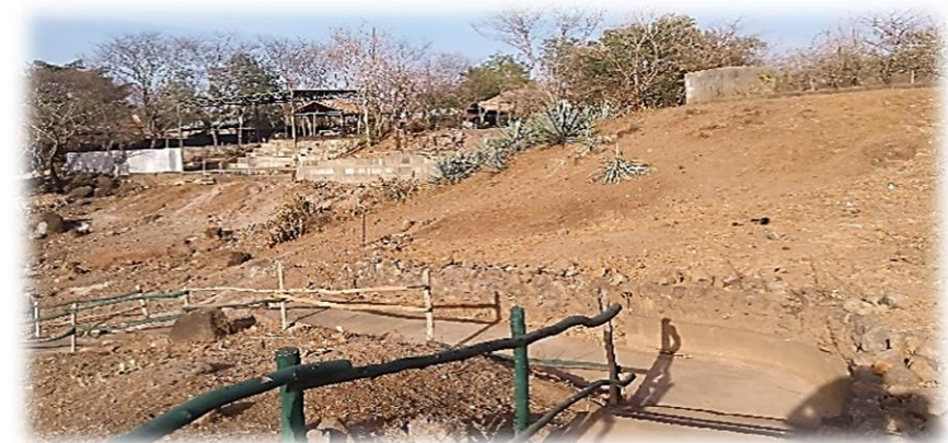
Imagen 4. Estado Actual de Pasamanos, Estilo Rustico. (CTHSJ).
