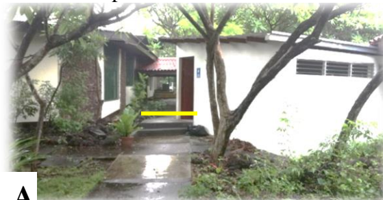
Imagen 44. Acceso peatonal a Baños Mujeres no cuenta con rampas de acceso.
