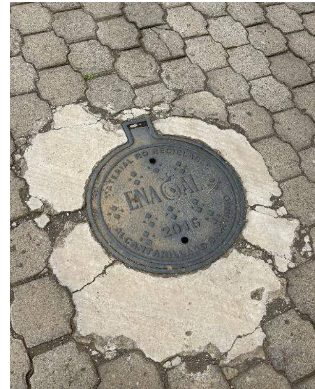
Ilustración 63. Pozo de Visita.
