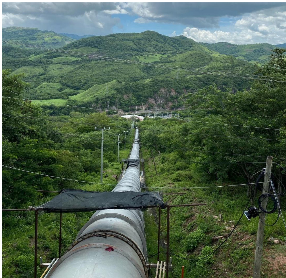
TUBERÍA FORZADA, CONDUCCIÓN DEL AGUA HASTA CASA DE MÁQUINA
