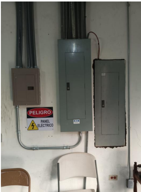
Ilustración 44 Paneles eléctricos en el área de recepción.
