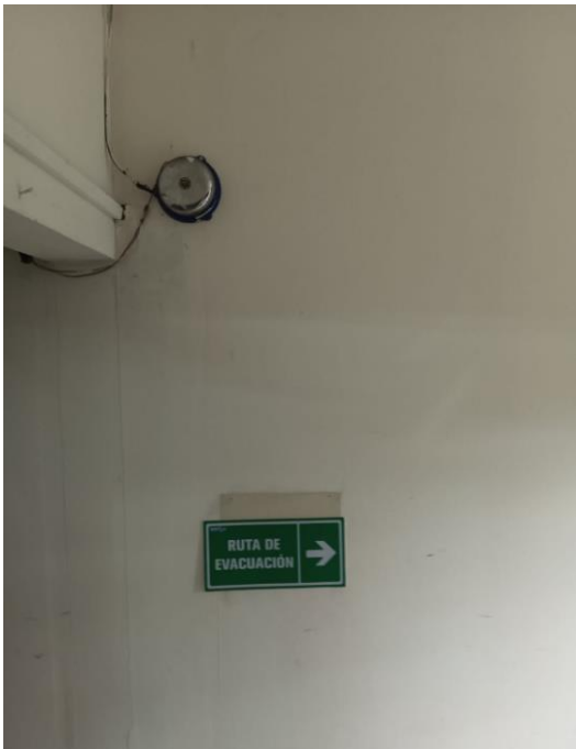
Ilustración 50 Alarma sonora para evacuación ubicada en al pasillo principal interno.
