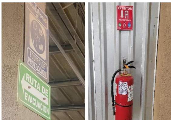
Figura 3. Señalizaciones en el área de fabricación de cajas
