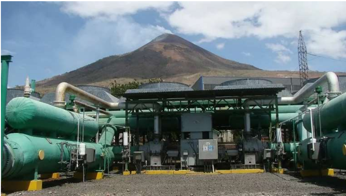
Ilustración 12 Planta Momotombo. Fuente: https://enel.gob.ni/geotermicas/ .
