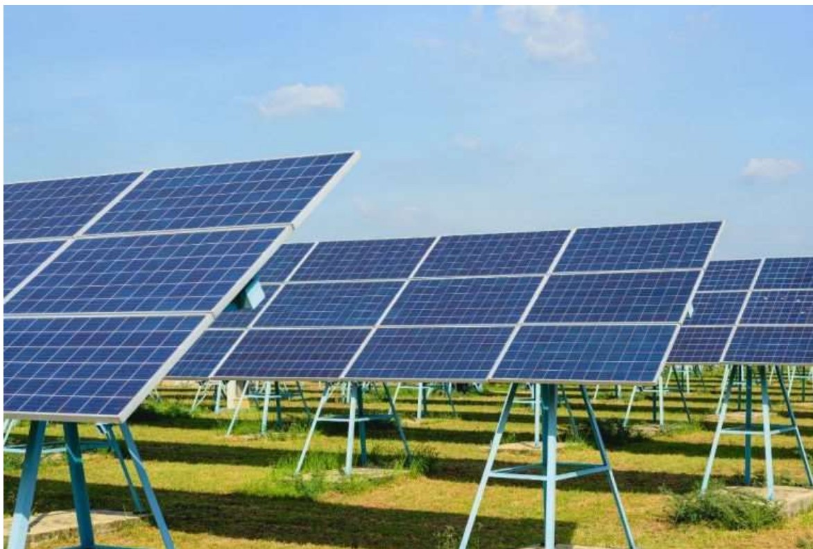
Ilustración 3 Proyecto de la alemana Recom en Nicaragua, fuente: https://nicaraguainvestiga.com/economia/147713-regimen-otorga-a-newton-energy-licencia-por-30-anos-para-planta-de-energia-solar-en-puerto-sandino/ .
