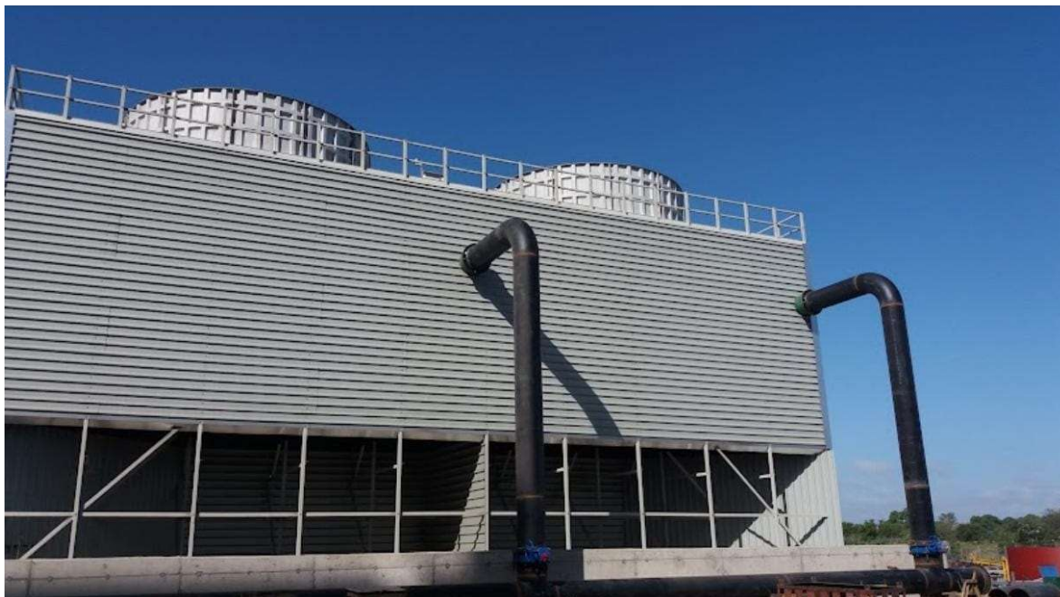
Ilustración 23. Empresa Generadora De Energía Renovable De Rivas, S.A (EGERSA). Fuente: https://lh3.googleusercontent.com/p/AF1QipMGitQ_eZgKsvAVXvXtj4PRcHajfePPPxJzuRTe=s680-w680-h510 .
