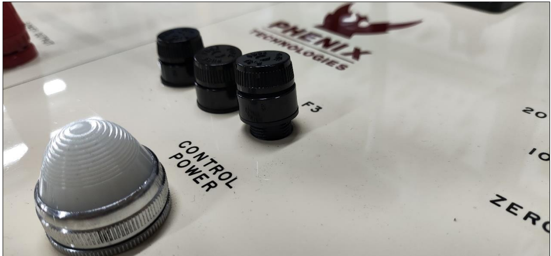
Figura 29: Estado del fusible F3
