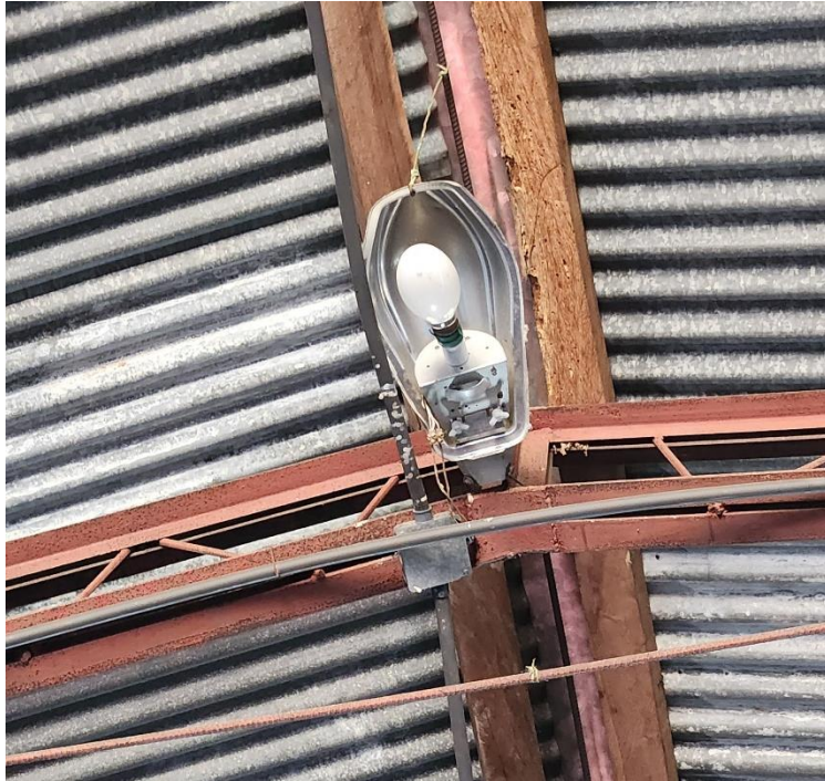
Figura #8: Lamparas de vapor de sodio de alta presión utilizadas en Auditorio
