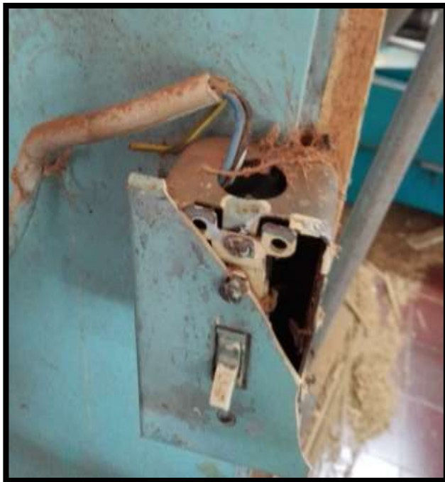
Ilustración.9. Instalaciones eléctricas de máquinas en mal estado
