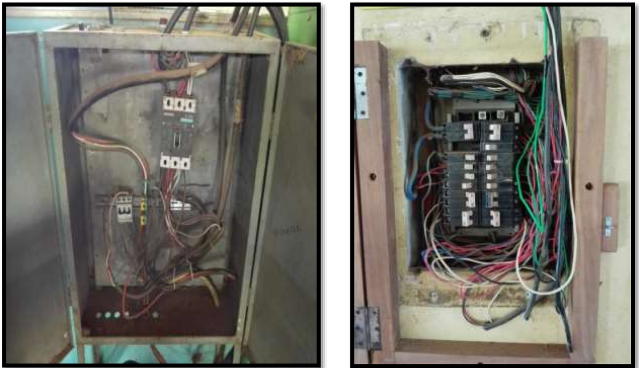
Ilustración 8. Paneles eléctricos no adecuados
