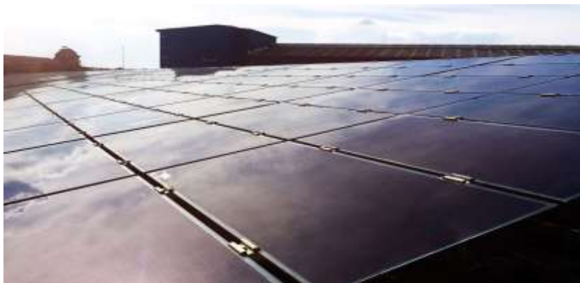
Figura No.12 , Panel Solar Amorfo. (Besun Energy, 2025).
