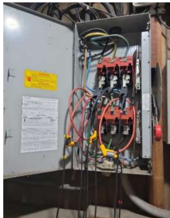
Figura No.36, Medición en Transferencia Eléctrica de Almacén - APC
