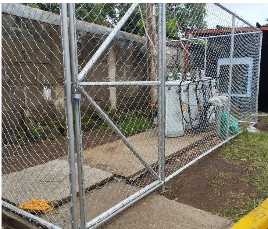
Figura 7: Banco de Transformador BT02 Frente a Bodega Administrativa
