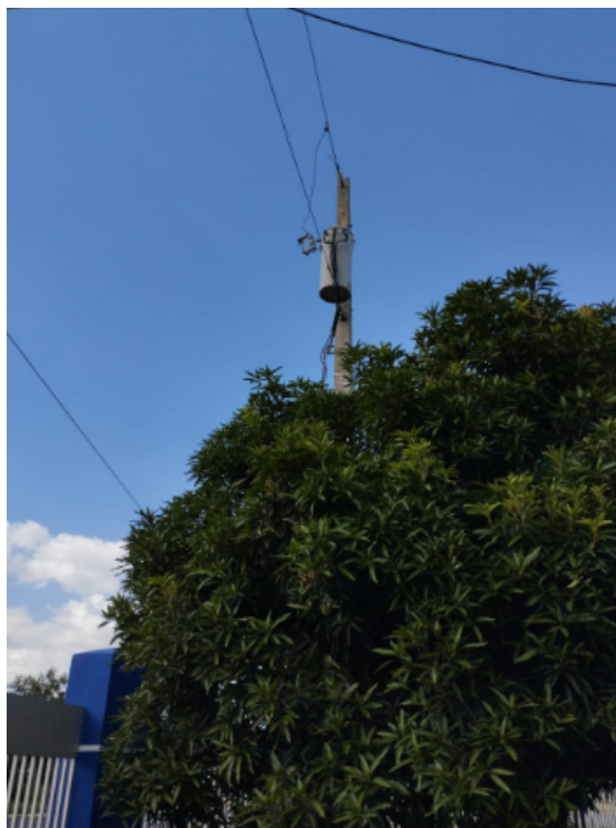
Figura 24: Banco de Transformador BT19 Suroeste pabellón Albert Einstein
