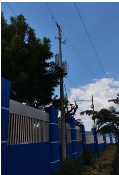
Figura 22: Banco de Transformador BT17 Contiguo al Edificio Ing. Carlos Santos Berroteran
