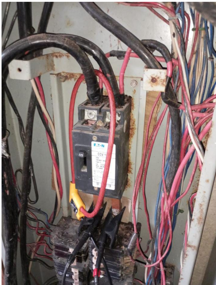
Figura 56: Tablero de distribución del Panel BT07.3
