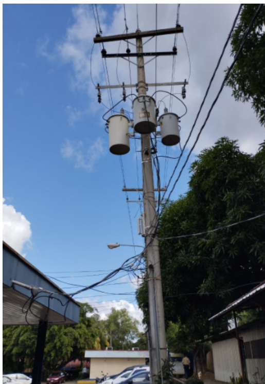
Figura 11: Banco de Transformador BT06 Frente al Salón de Danza
