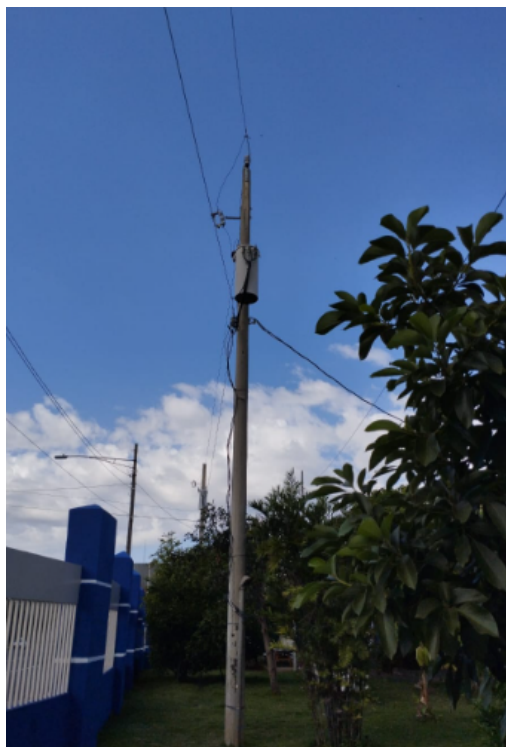
Figura 23: Banco de Transformador BT18 Suroeste pabellón Albert Einstein
