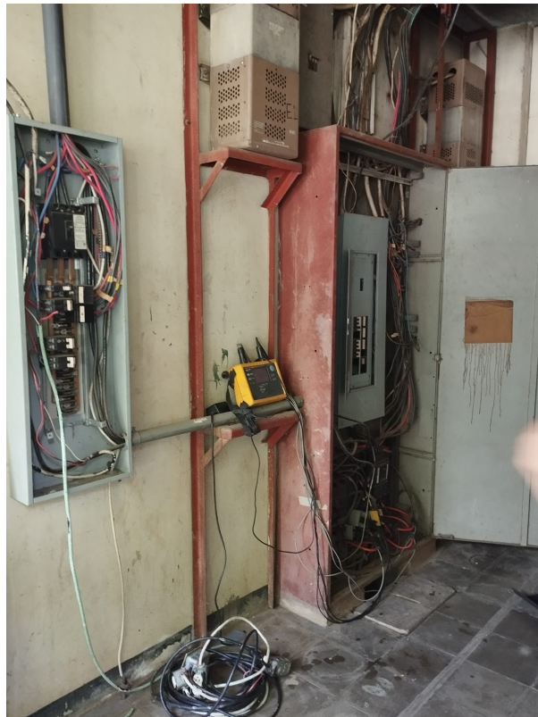
Figura 45: Instalación Fluke 1735 en el Panel BT02.6
