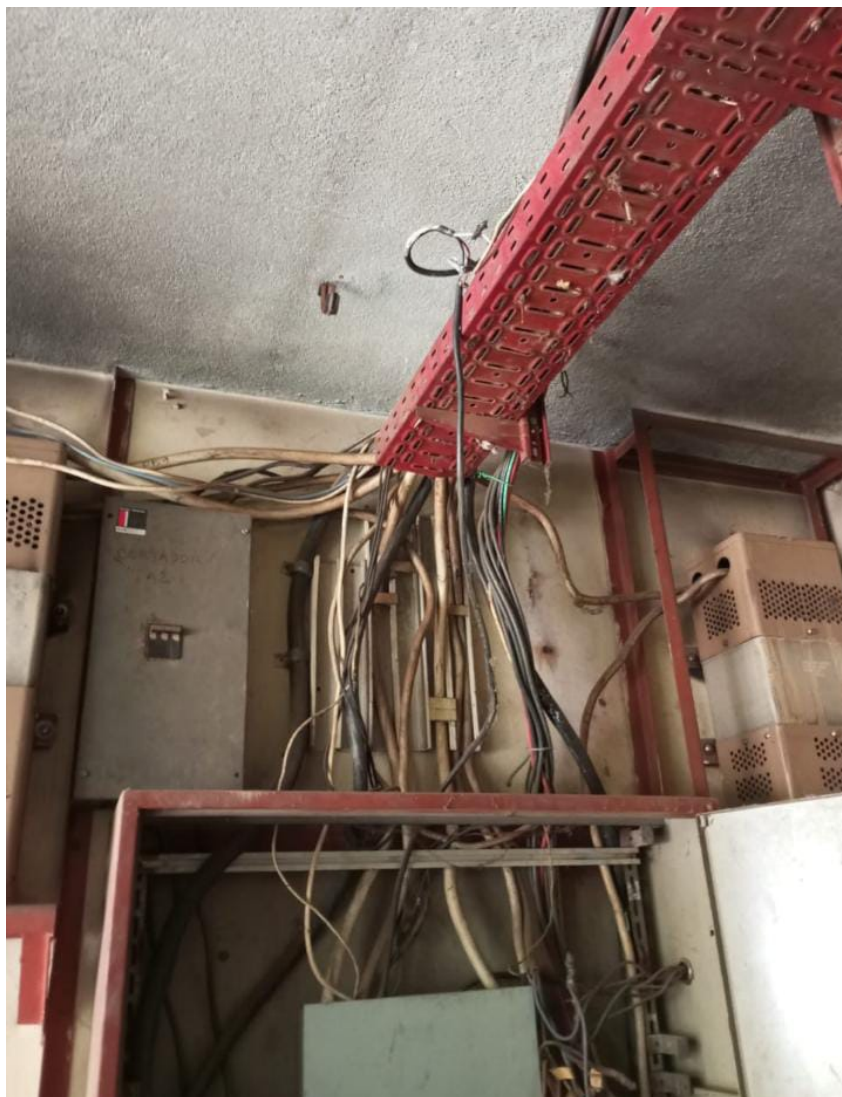
Figura 55: Bandeja de cables del Panel BT02.5
