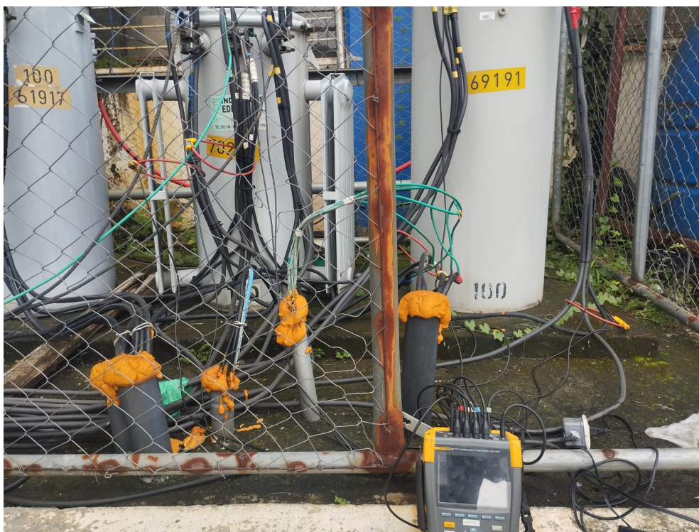
Figura 8: Banco de Transformador BT03 Frente Dirección de Registro Central
