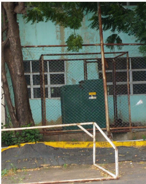
Figura 18: Banco de Transformador BT13 Contiguo a Lab. Operaciones Unitarias
