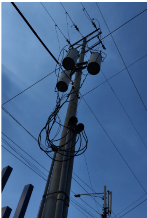
Figura 21: Banco de Transformador BT16 Contiguo al Edificio Ing. Carlos Santos Berroteran
