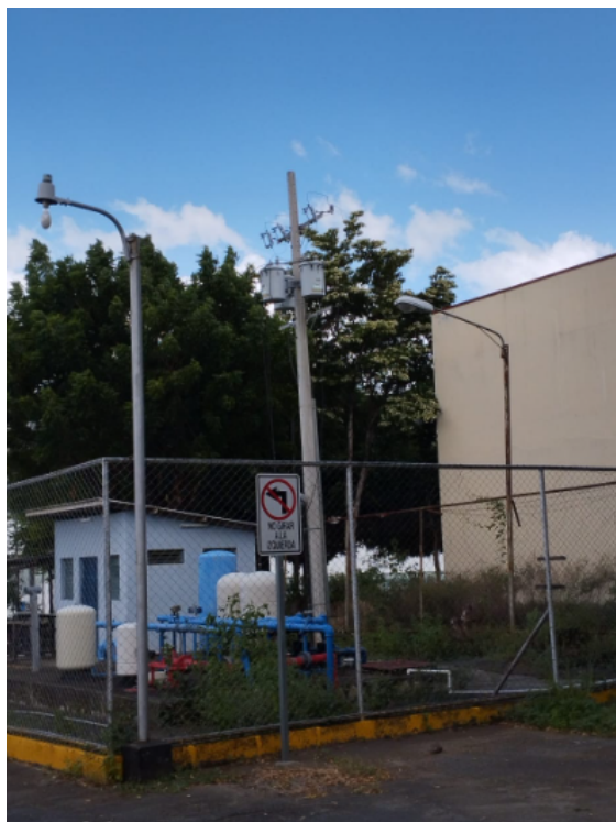
Figura 19: Banco de Transformador BT14 Bomba de Agua ERLP
