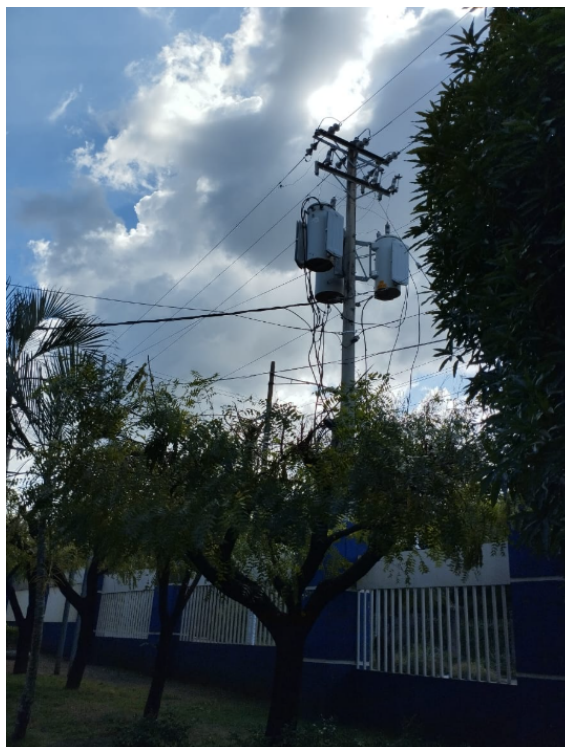
Figura 20: Banco de Transformador BT15 Suroeste Biblioteca Esman Marín
