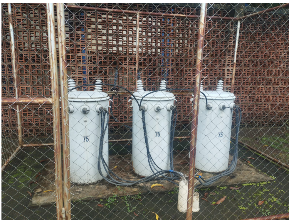
Figura 6: Banco de Transformador BT01 Frente a oficina Piensa
