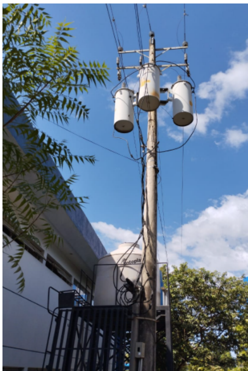
Figura 14: Banco de Transformador BT09 UNI Posgrado
