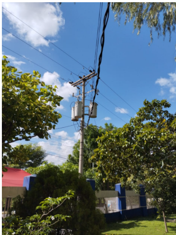
Figura 9: Banco de Transformador BT04 Costado Noroeste de Registro Central
