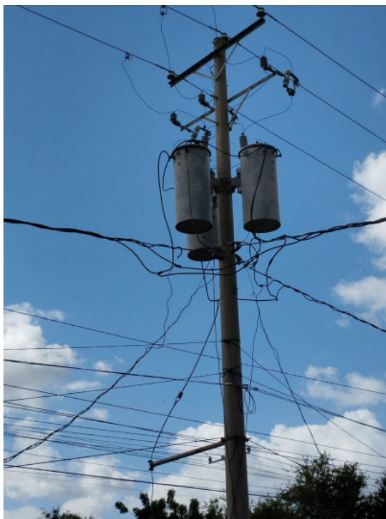
Figura 10: Banco de Transformador BT05 Costado noroeste Food - Court
