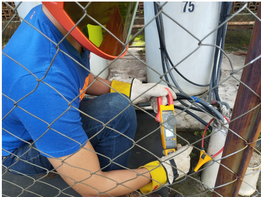
Figura 43: Instalación del equipo en el banco BT01
