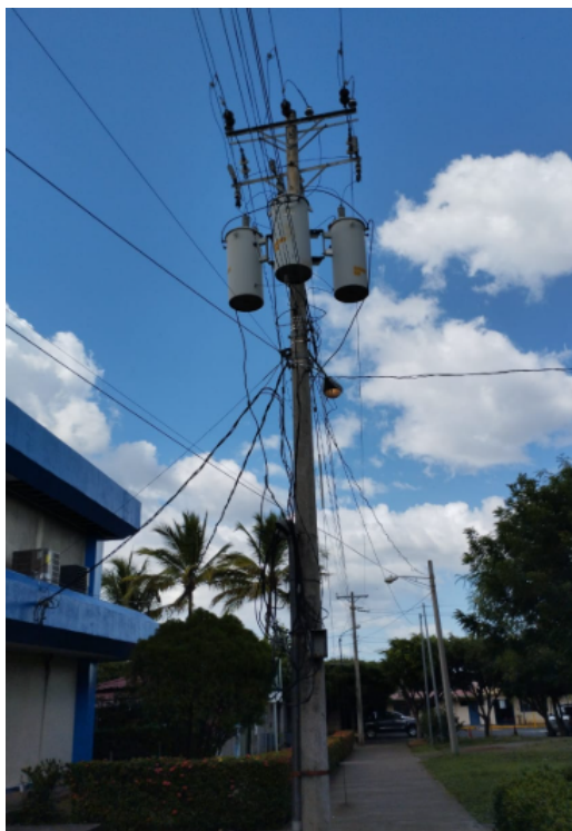
Figura 17: Banco de Transformador BT12 Costado Este de Caja del Albert Einstein
