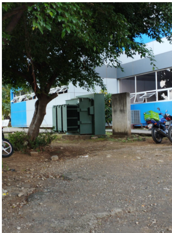
Figura 16: Banco de Transformador BT11 Jardines ala A Edificio 01
