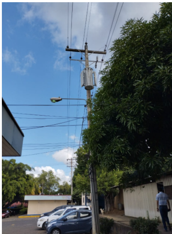
Figura 12: Banco de Transformador BT07 Contiguo al Cafetin Duarte
