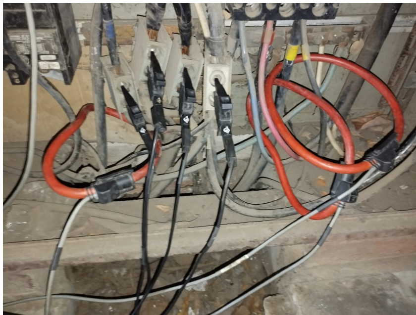
Figura 44: Estado de Borneras y Tablero en el Panel BT02.5
