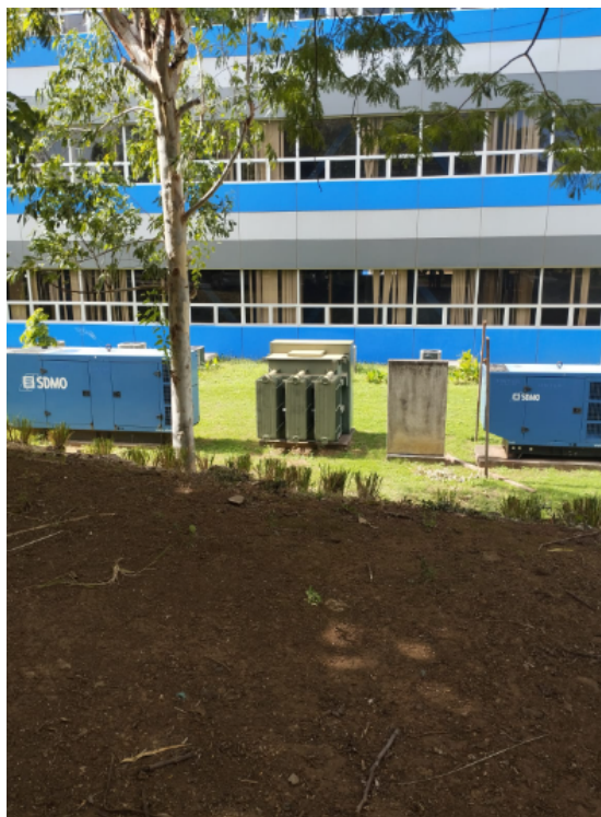
Figura 15: Banco de Transformador BT10 Jardines ala B Edificio 01
