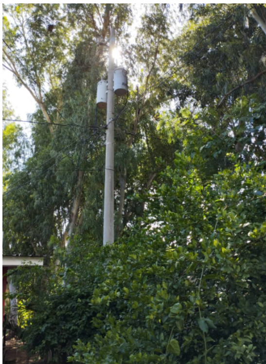
Figura 13: Banco de Transformador BT08 Contiguo al Comedor estudiantil
