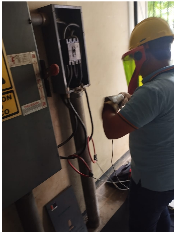
Figura 47: Instalación Equipo en el Panel BT02.7
