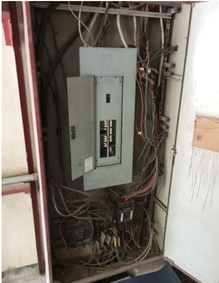
Figura 50: Tablero en estado deficiente del Panel BT02.5
