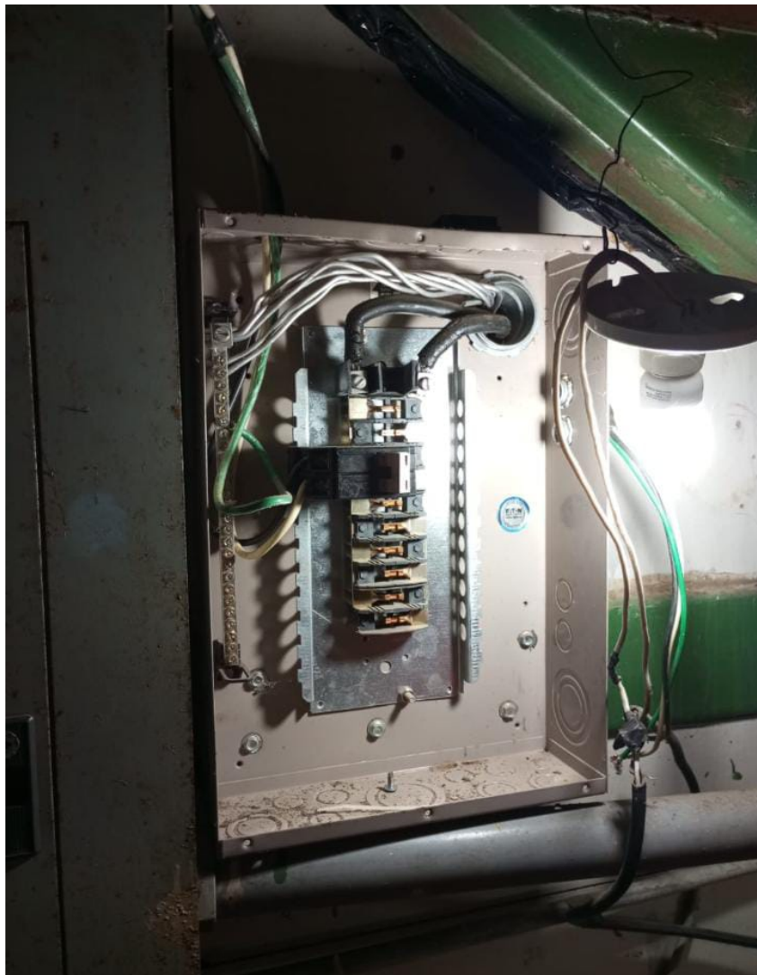
Figura 54: Tablero de distribución del Panel BT17.1.1
