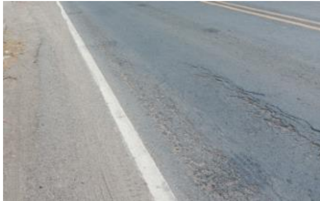
Figura 60. FISURA PIEL DE COCODRILO - ESTACION 185+400
