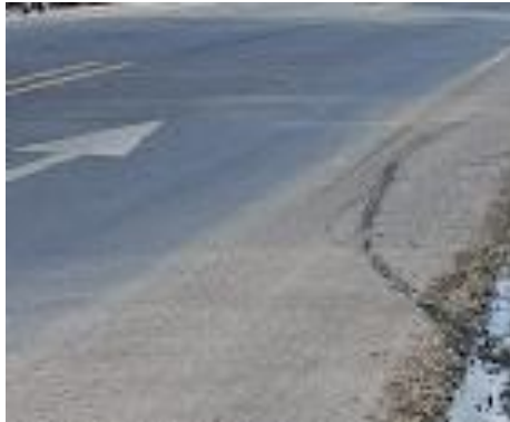
Figura 63. DESINTEGRACION DE BORDES CON ACUMULACION DE AGUA ESTACION 185+700
