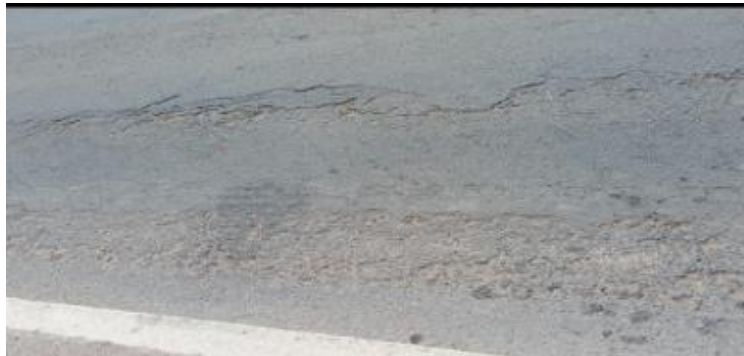
Figura 61. FISURA PIEL DE COCODRILO - ESTACION 185+500
