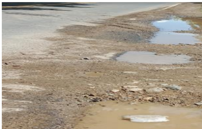
Figura 56. DESINTEGRACION DE BORDES CON ACUMULACION DE AGUA ESTACION 185+000
