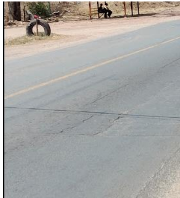
Figura 76. FISURA EN BLOQUE – ESTACION 187+000
