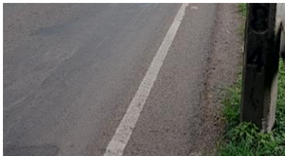
Figura 46. FISURA LONGITUDINAL - ESTACION 184+000
