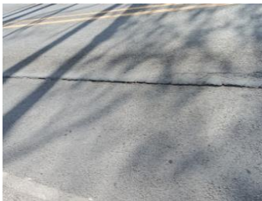
Figura 69. FISURA POR REFLEXION DE JUNTA – ESTACION 186+300
