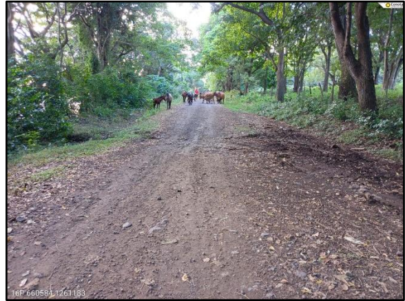
Cruce de agua sin obra de drenaje Estación: 6+900
