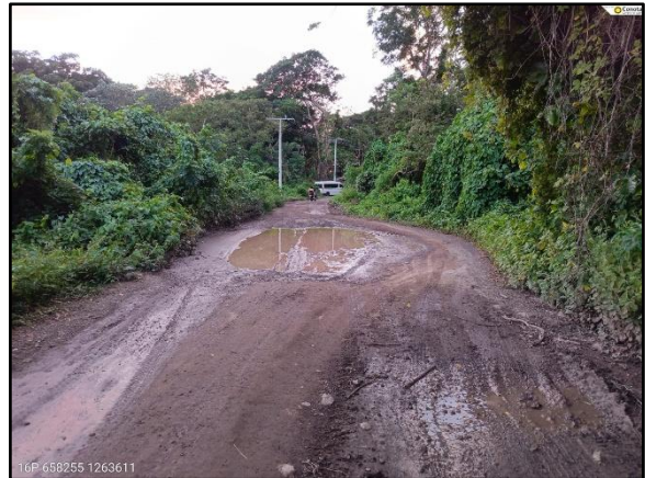
Acumulación de agua sobre el camino Estación: 11+000
