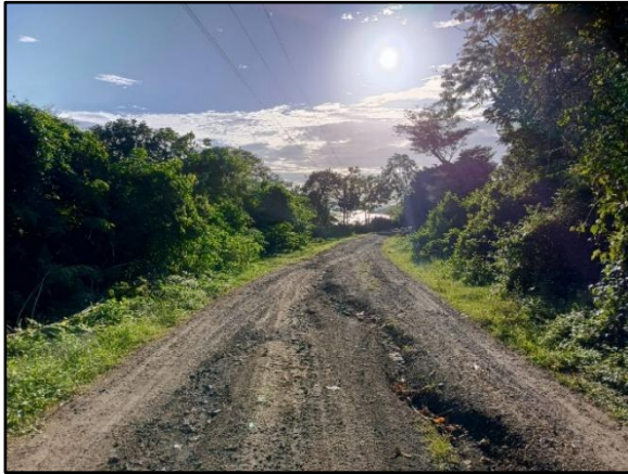
Deformación superficial por escorrentía Estación: 0+240
